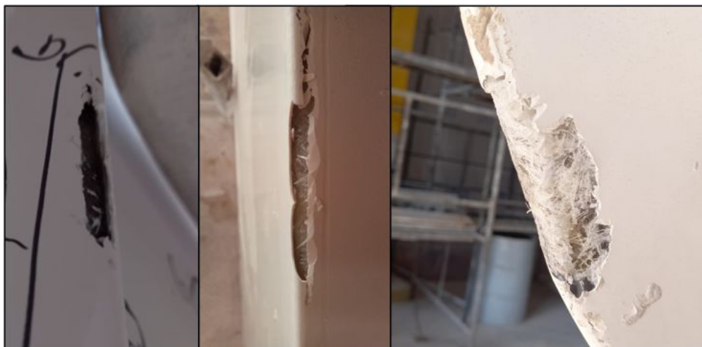
Figura 11 – Cantos comprometidos em embarcações devido à vazios entre camadas do laminado.
