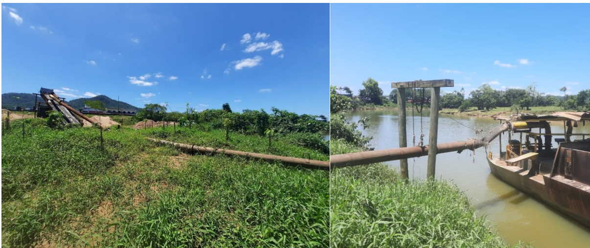
Figura 2 - Tubulação de recalque. A esquerda conectada ao despejo na bacia de decantação. A direita conectada a balsa. Fonte: a autora.
