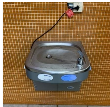
Figura 13 - Bebedouro localizado no pavimento térreo.
