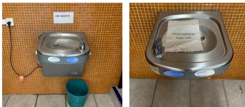
Figura 14 – Bebedouros interditados localizados no pavimento superior.
