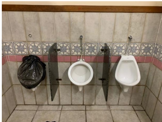
Figura 12 – Mictório com acionamento hidromecânico.
