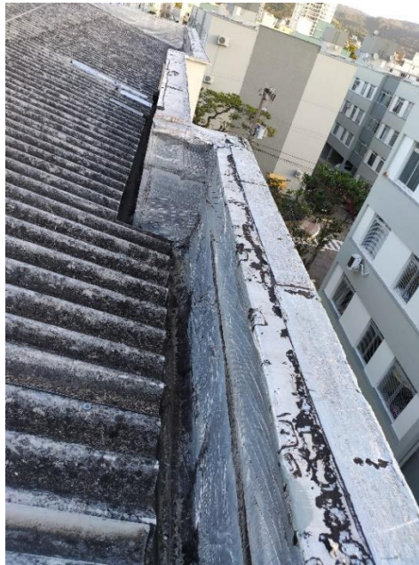
Figura 7 - Calha de captação horizontal da cobertura do bloco B5.
