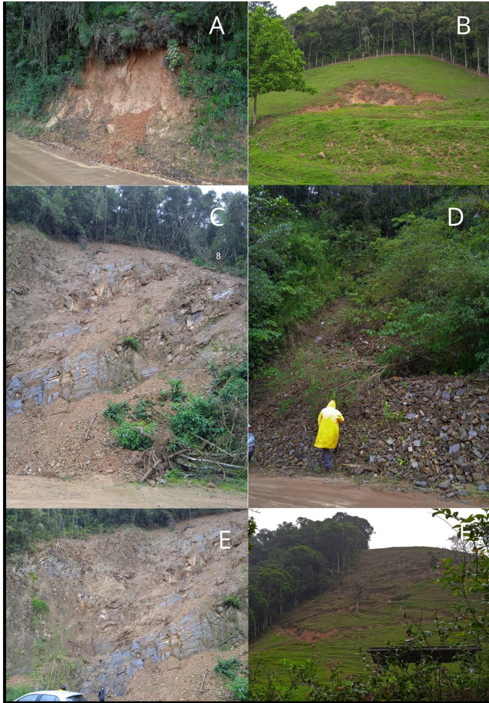
Figura 23: Movimentos gravitacionais de massa identificados em trabalho de campo. A) Escorregamento Translacional em beira de estrada (DSL-06). B e F) Rastejos em estágio avançado em áreas de pastagem (DSL-05 e DSL-10). C e E) Escorregamento de grande proporção em beira de estrada, ocorrido em siltitos e argilitos da Bacia do Itajaí, marcando indícios de queda de rocha mesmo após sua ocorrência (DSL-07). D) Escorregamento em beira de estrada ocorrido em ritmitos da Bacia do Itajaí (DSL-10).
