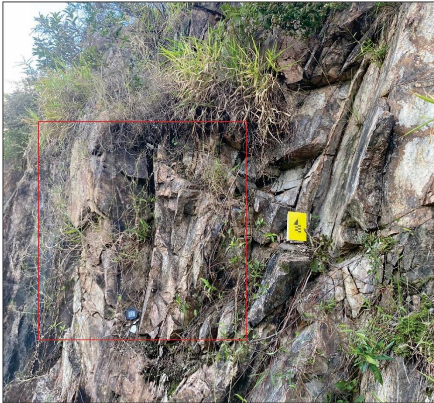
Figura 28. Planos de falhas encontrados no talude, evidenciando estrutura de tombamento em blocos com orientação N-S.
