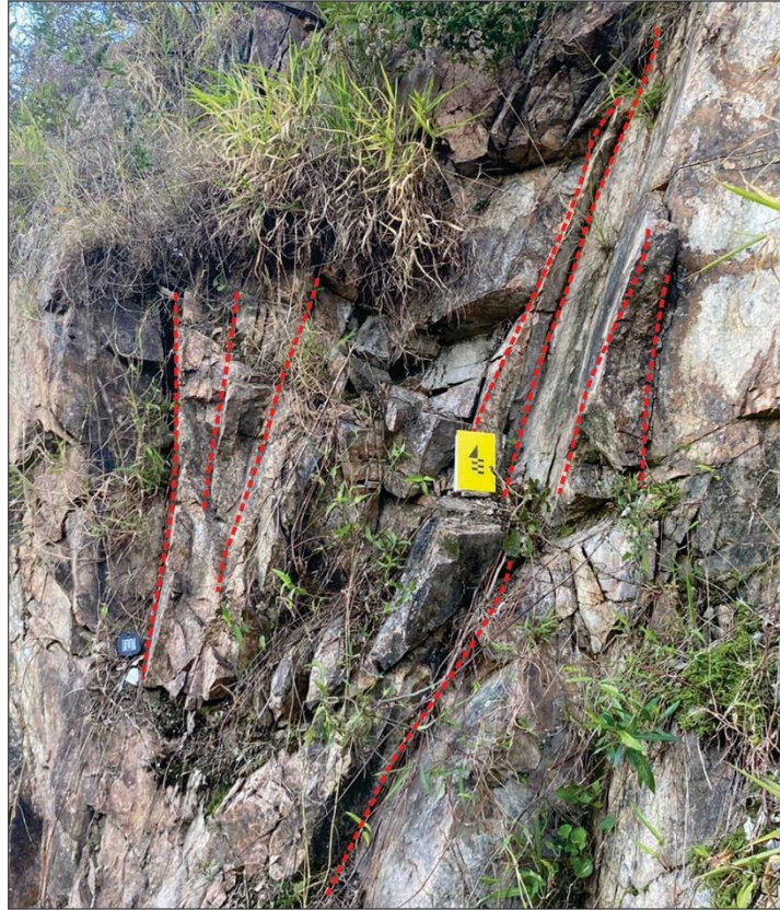
Figura 30. Planos de fraturas (sub)verticais com direção N20E e N-S, família de fratura com maior persistência no talude.
