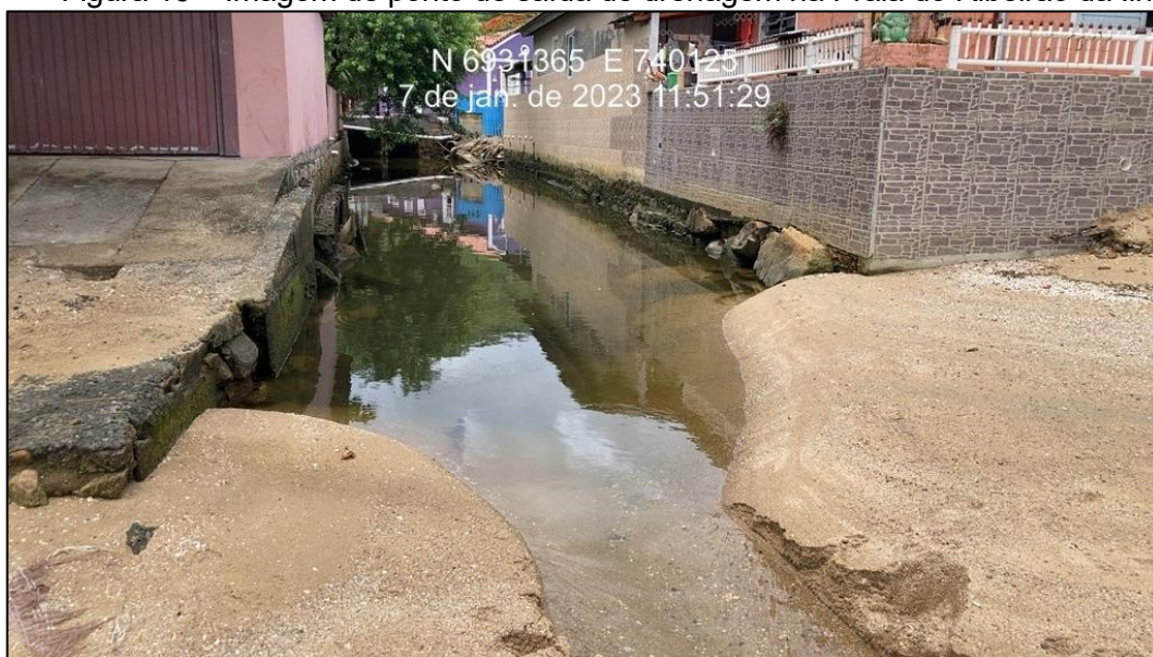
Figura 16 – Imagem de ponto de saída de drenagem na Praia do Ribeirão da Ilha
