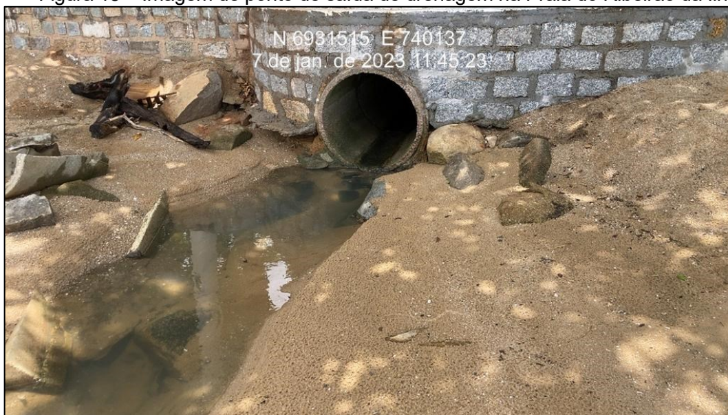
Figura 15 – Imagem de ponto de saída de drenagem na Praia do Ribeirão da Ilha
