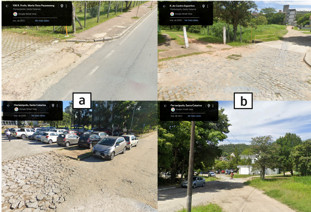
Figura 75 - Passeios e vias irregulares nas vias internas do Campus Trindade
