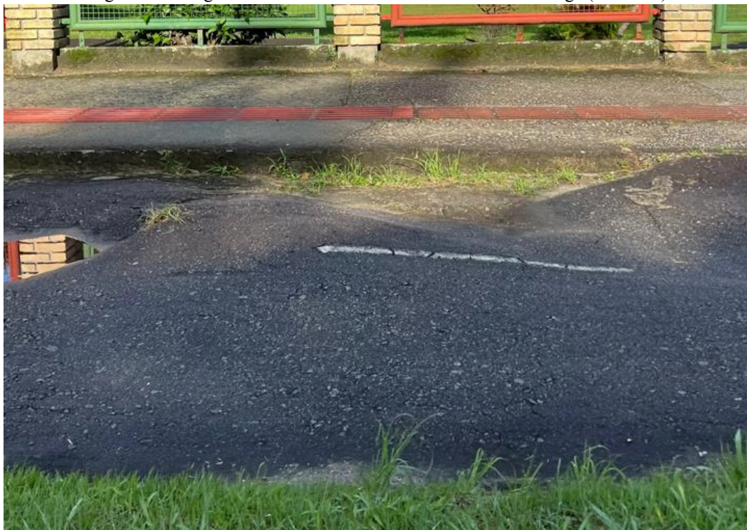
Figura 68 - Irregularidades no trecho da Rodovia Admar Gonzaga (Itacorubi)
