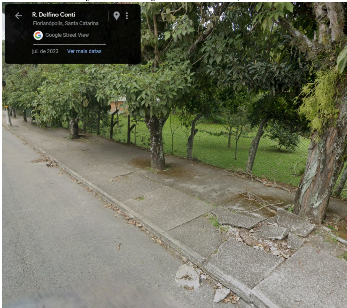
Figura 73 - Passeio irregular na Rua Delfino Conti (Trindade)
