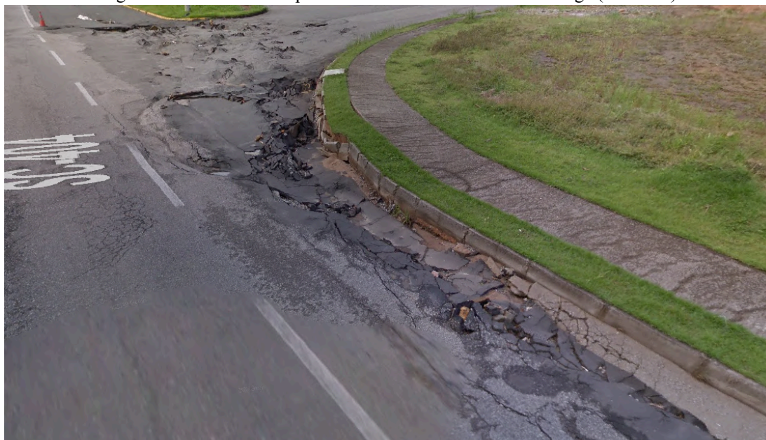
Figura 93 - Problemas no pavimento da Rodovia Admar Gonzaga (Itacorubi)
