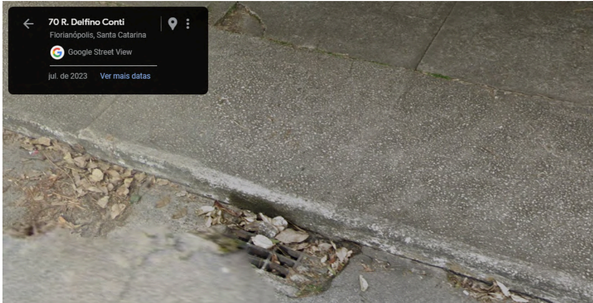
Figura 79 - Grelha de drenagem obstruída na Rua Delfino Conti (Trindade)
