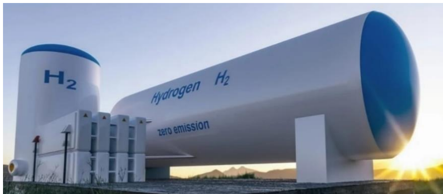
Figura 13 - Tanque de armazenamento de H 2 .
