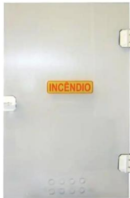
Figura 12 – Abrigo hidrante ou mangotinho em vidro
