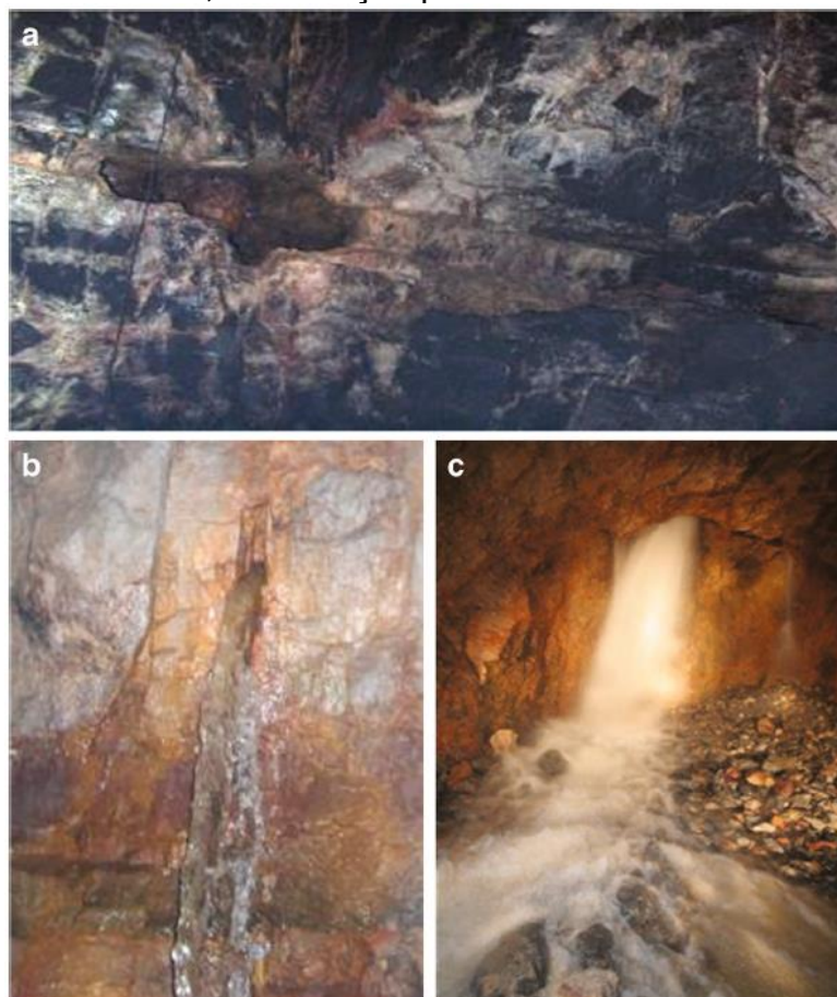
Figura 19 – a. Infiltração por gotejamento da porosidade secundária, b. infiltração por fraturas, c. infiltração por condutos cársticos.
