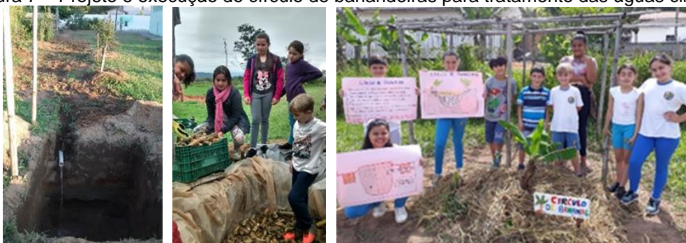
Figura 7 – Projeto e execução do círculo de banadeiras para tratamento das águas cinzas.
