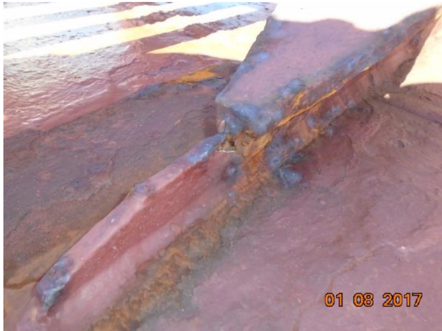
Figura 17 - Trinca na braçola da escotilha
