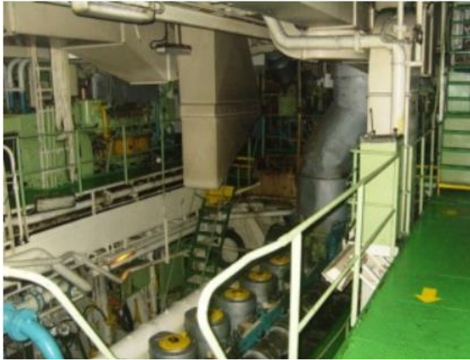
Figura 19 - Praça de máquinas
