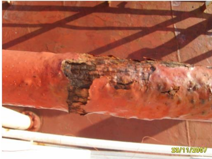
Figura 10 - Corrosão excessiva na rede do convés
