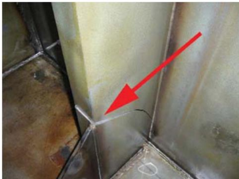
Figura 14 - Trinca em ponto duro
