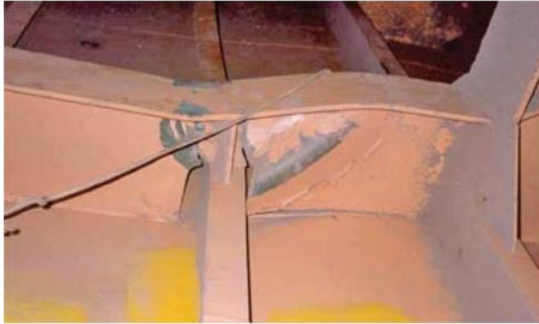
Figura 13 - Distorção na estrutura do casco
