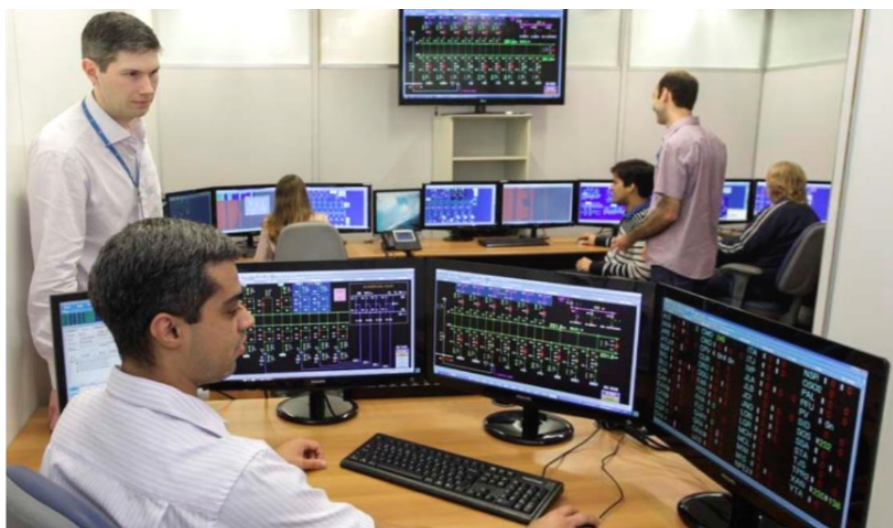
Figura 3 – Posto de treinamento na sede da Eletrobras CGT Eletrosul
