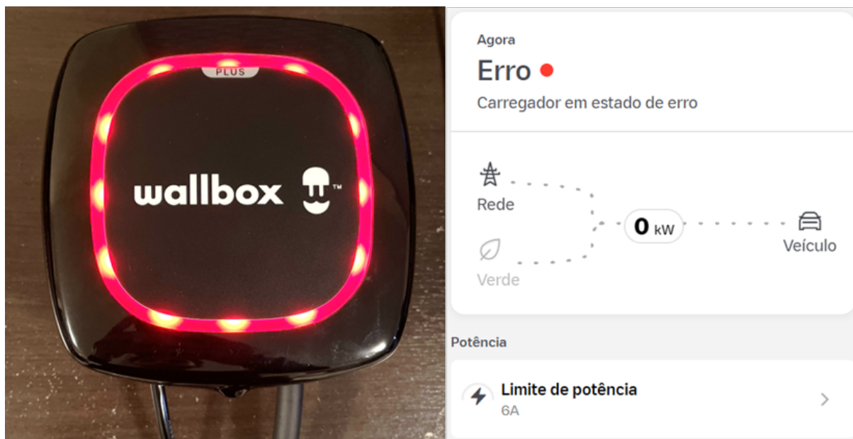
Figura 36 – Carregador em erro devido ao dispositivo requerer ventilação. Fonte: Elaboração Própria.
