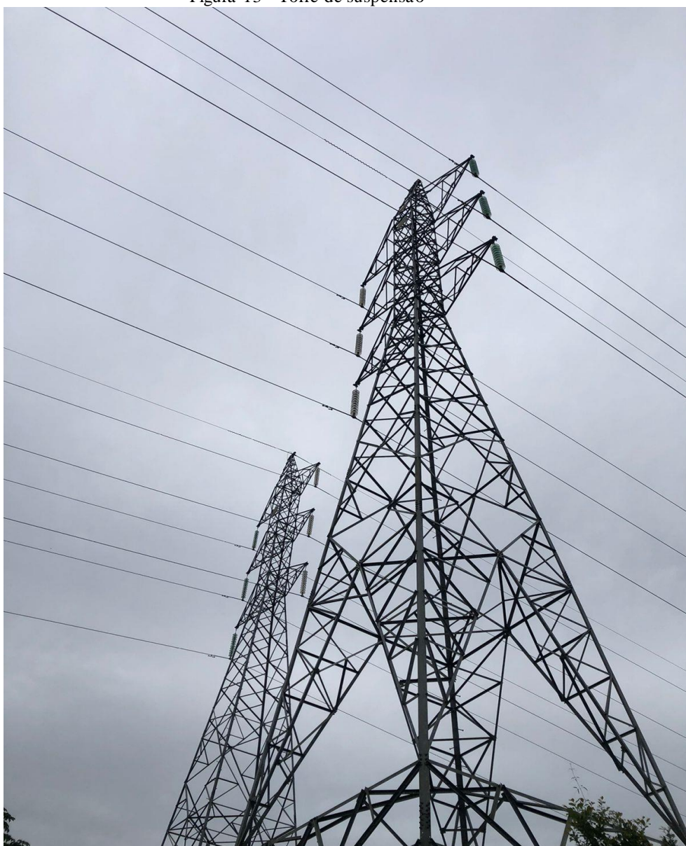
Figura 13 - Torre de suspensão
