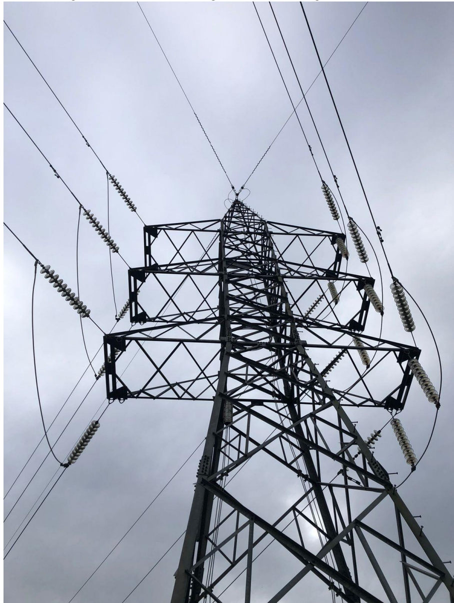
Figura 14 - Torre de ancoragem e de tensão angular
