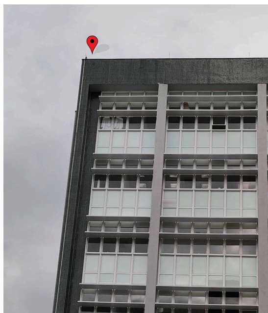
Figura 11 – A armadilha instalada por fita isolante na área de cobertura, representada a uma altura de mais de 26 metros de altura entre do solo, referente ao lado esquerdo (ponto 2).
