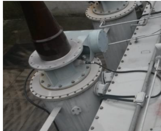
(b) Adaptador de TAP instalados.
