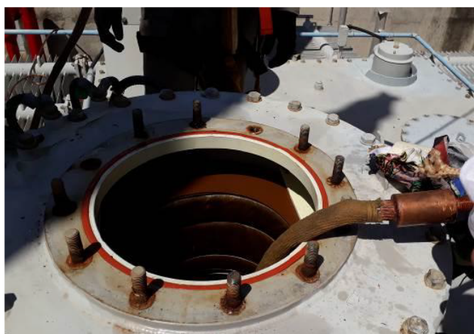
Figura 38 – Vista do condutor interno de AT (caso 1).
