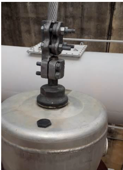
Figura 42 – Conexão da bucha na linha de 230 kV (caso 1).
