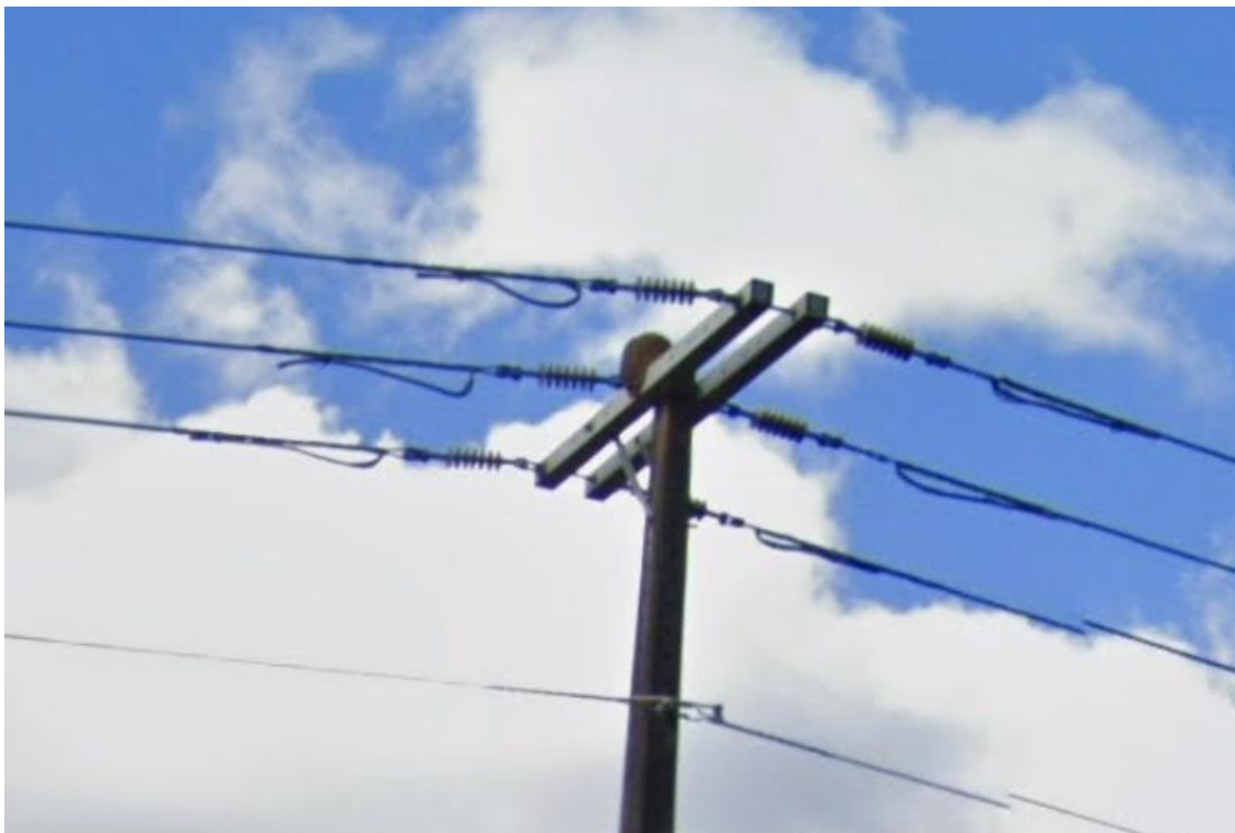
Figura 23 – Encontro de redes de 13,8 kV e 23 kV na mesma estrutura em Jaborá, SC
