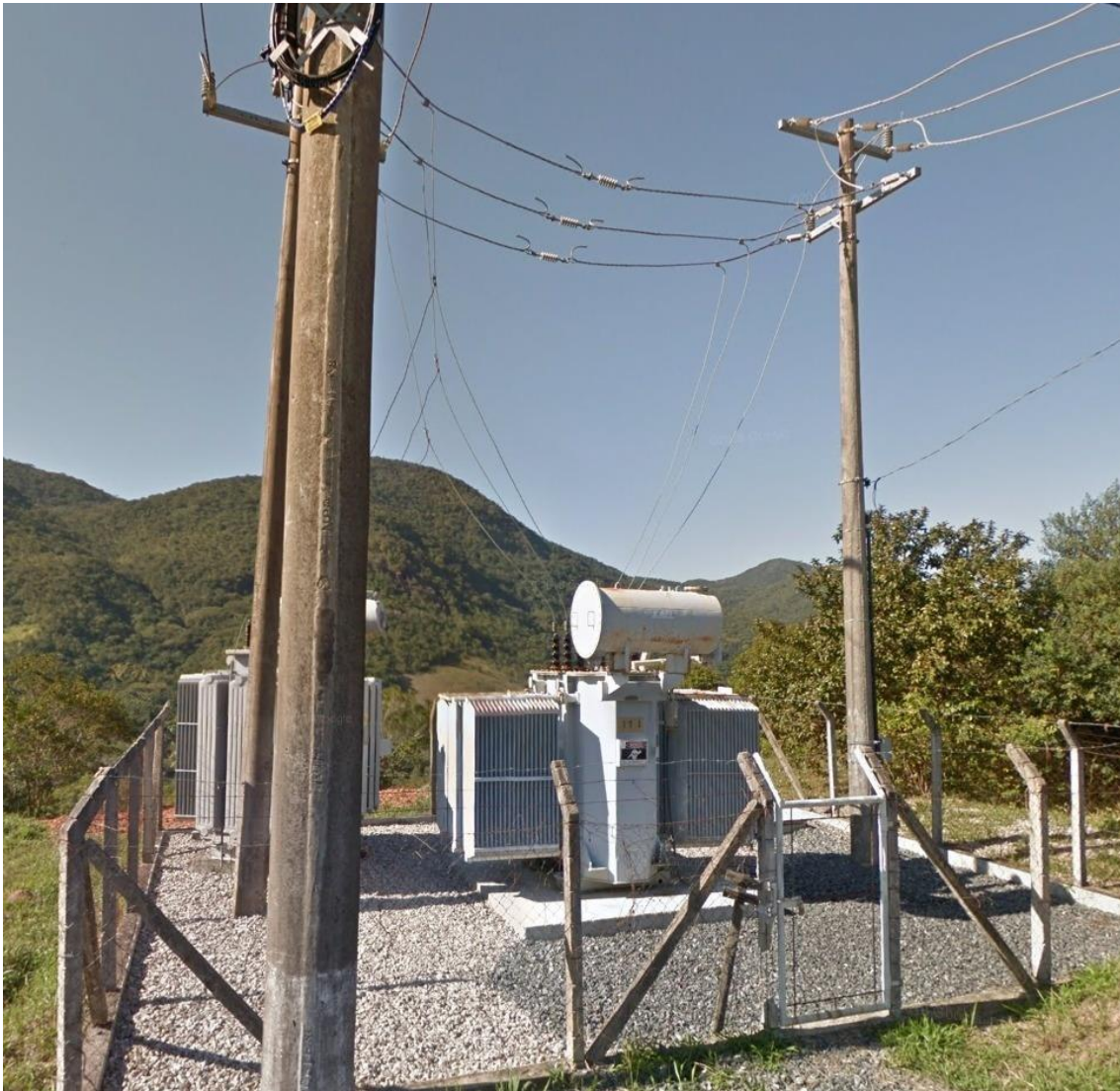
Figura 25 – Transformador elevador em Governador Celso Ramos, SC
