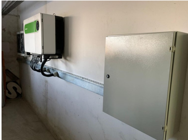
Figura 20 – Inversor fotovoltaico, quadros de proteção, infraestrutura elétrica
