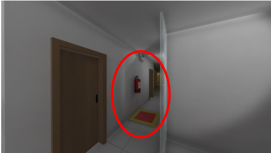
Figura 70 – Extintor no corredor estreito – TD6
