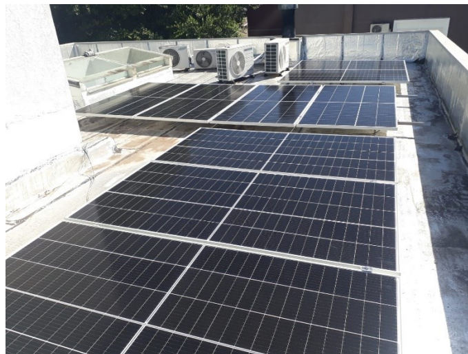
Figura 18 - Conjunto de módulos do Sistema FV 3
