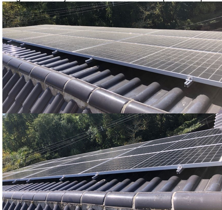
Figura 15 - Conjunto de módulos antes e depois da limpeza
