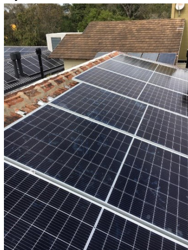
Figura 24 - Conjunto de módulos do Sistema FV 6
