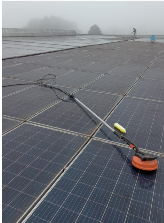
Figura 31 - Material para limpeza dos módulos fotovoltaicos. Imagem do Sistema FV 1
