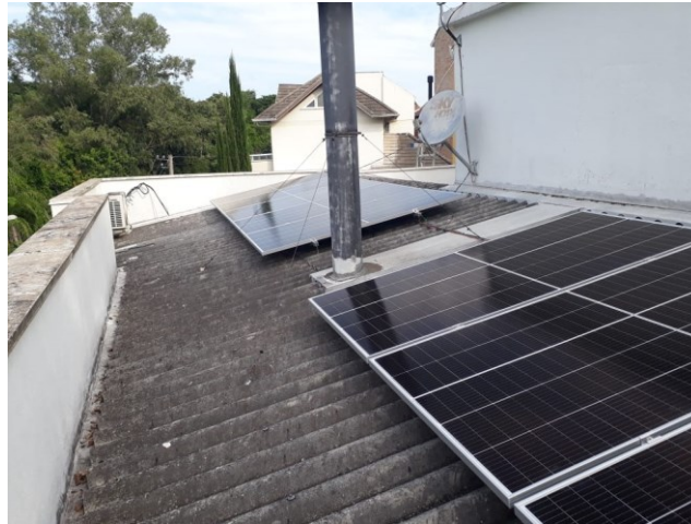
Figura 20 - Conjunto de módulos do Sistema FV 4
