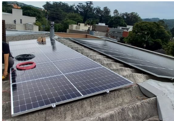
Figura 22 - Conjunto de módulos do Sistema FV 5
