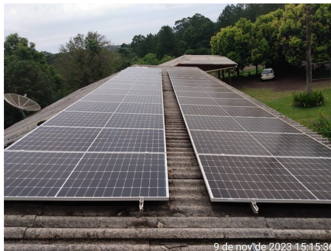
Figura 30 - Conjunto de módulos do Sistema FV 8
