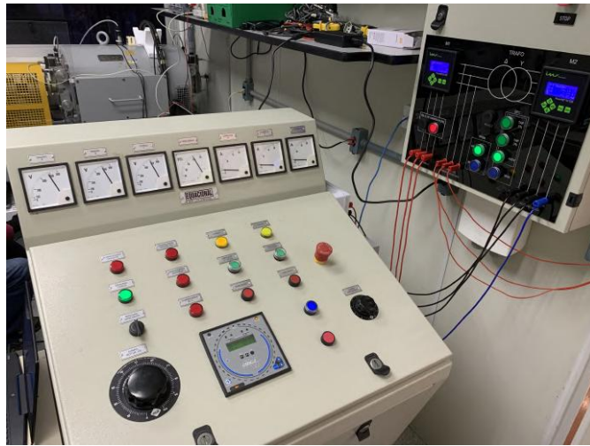
Figura 41 – Destaque para os painéis de controle e do banco de transformadores da bancada experimental.
