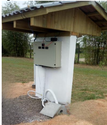
Figura 34 – Quadro de comando
