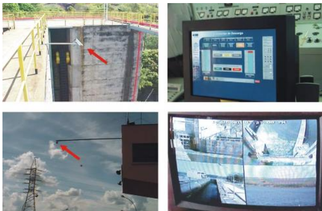
Figura 10 - Dispositivos de Segurança e monitoramento nas Eclusas.
