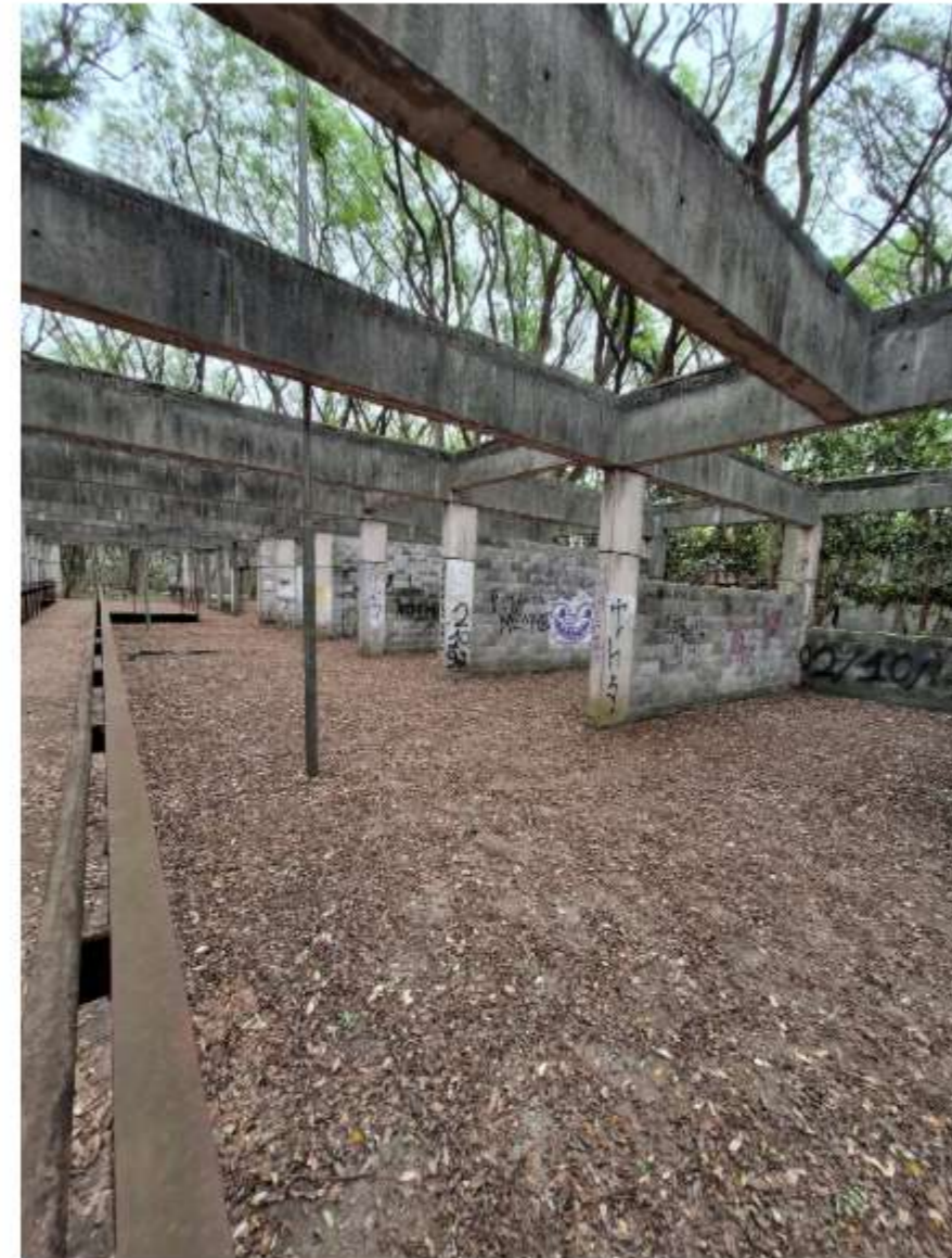
Ruínas e partes da estrutura do antigo Pavilhão 9 do complexo do Carandiru - Foto: Pedro Ordones
