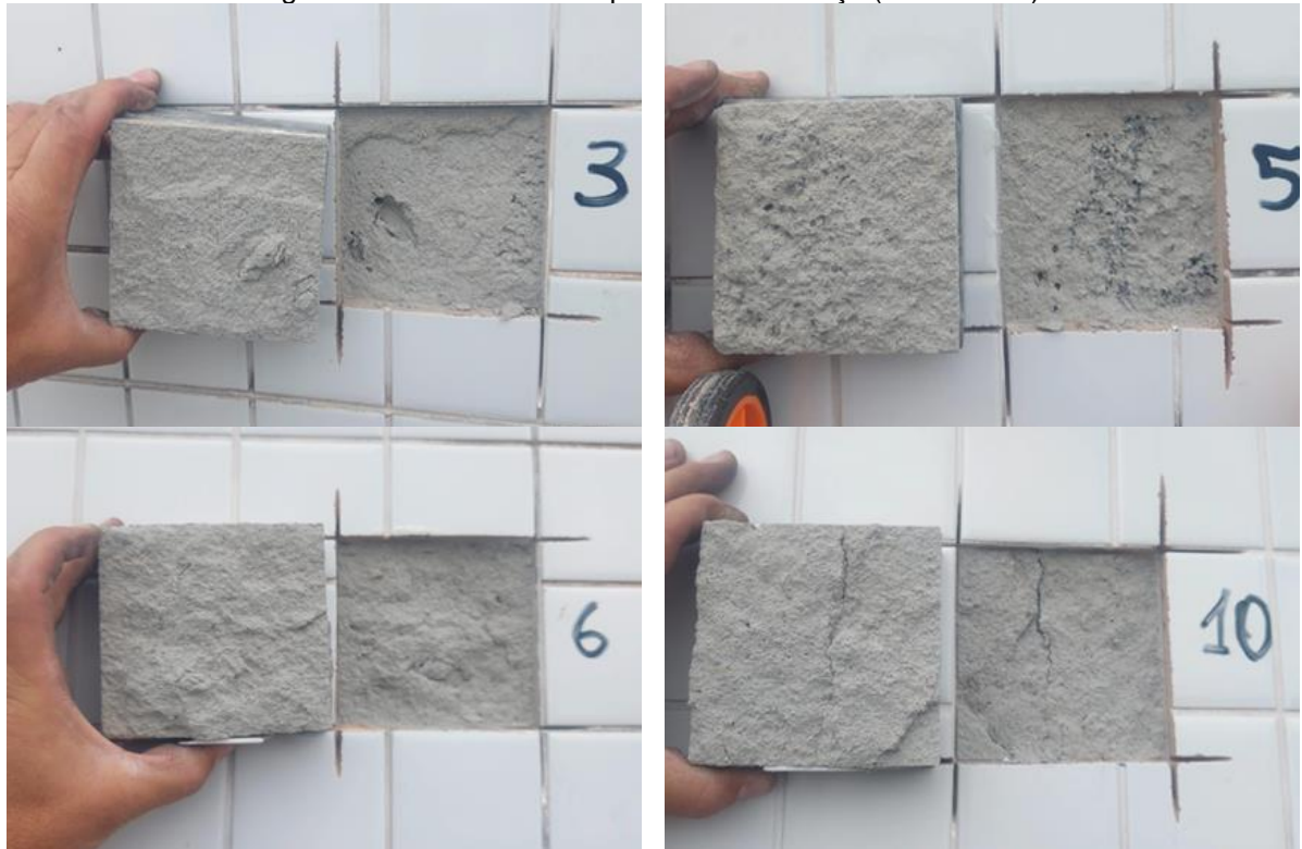
Figura 40 – Detalhe de rompimento no emboço (fachada sul)
