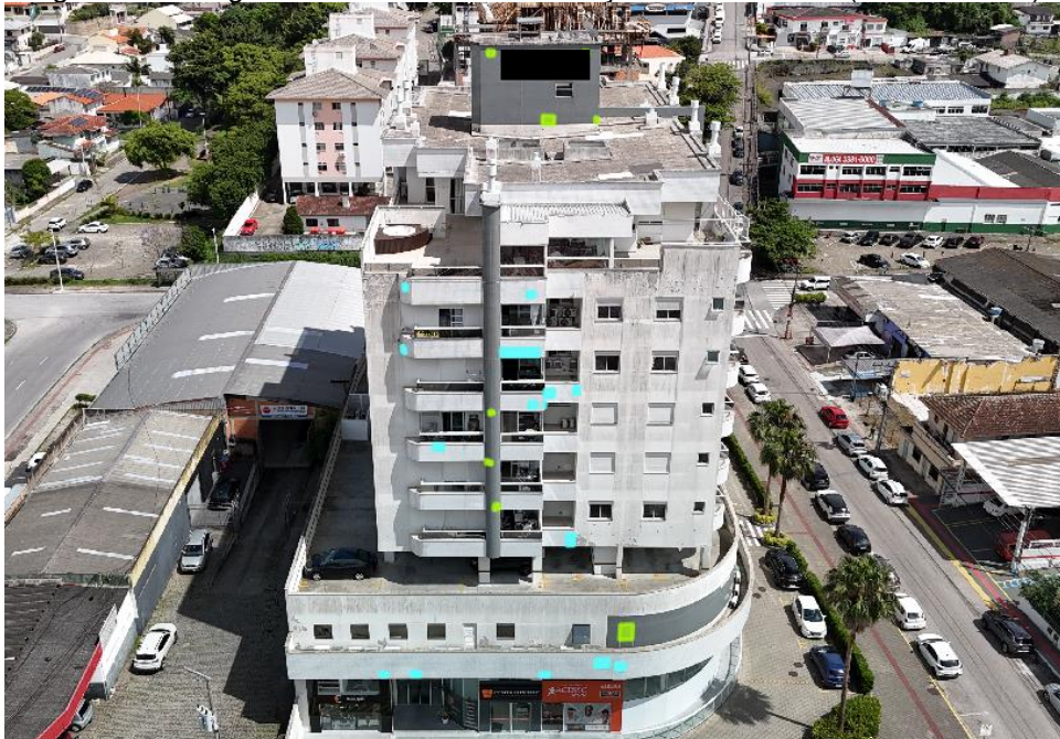
Figura 51 - Imagem de drone com as marcações de som cavo (fachada leste)
