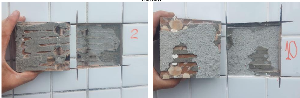
Figura 39 – Detalhe de rompimento entre argamassa colante/placa cerâmica e emboço (fachada norte).
