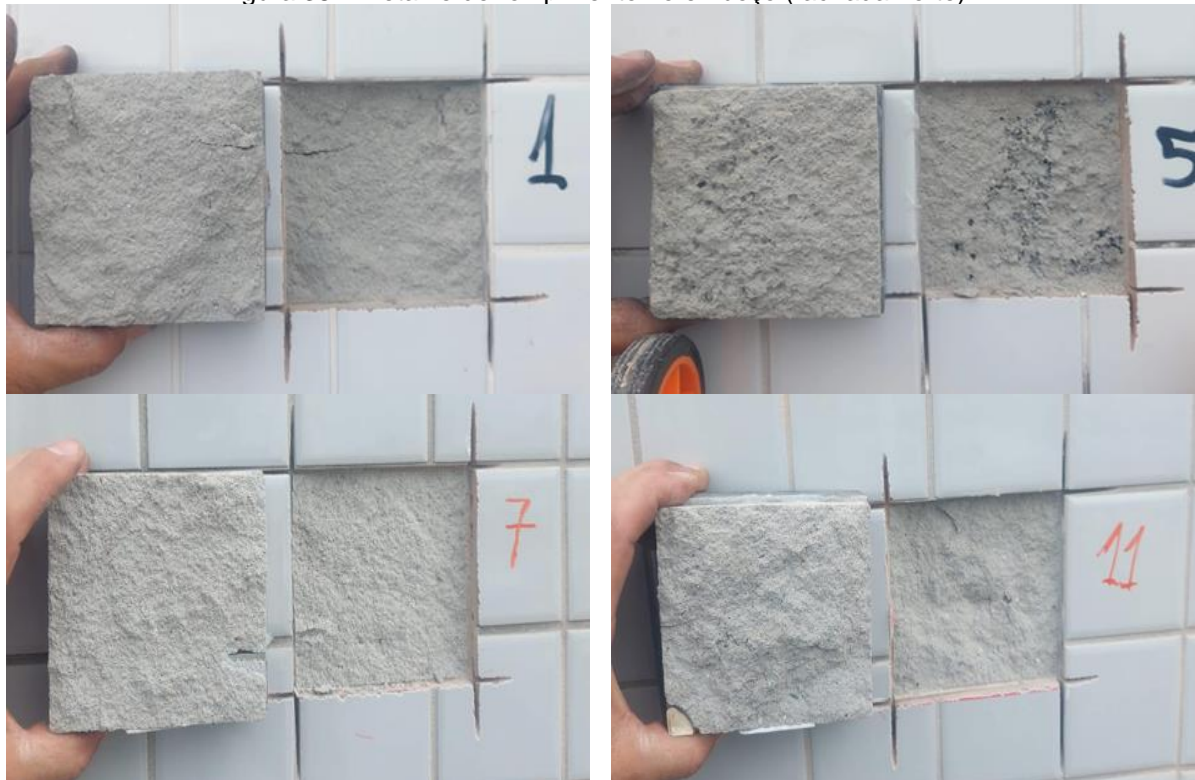
Figura 38 – Detalhe de rompimento no emboço (fachada norte).
