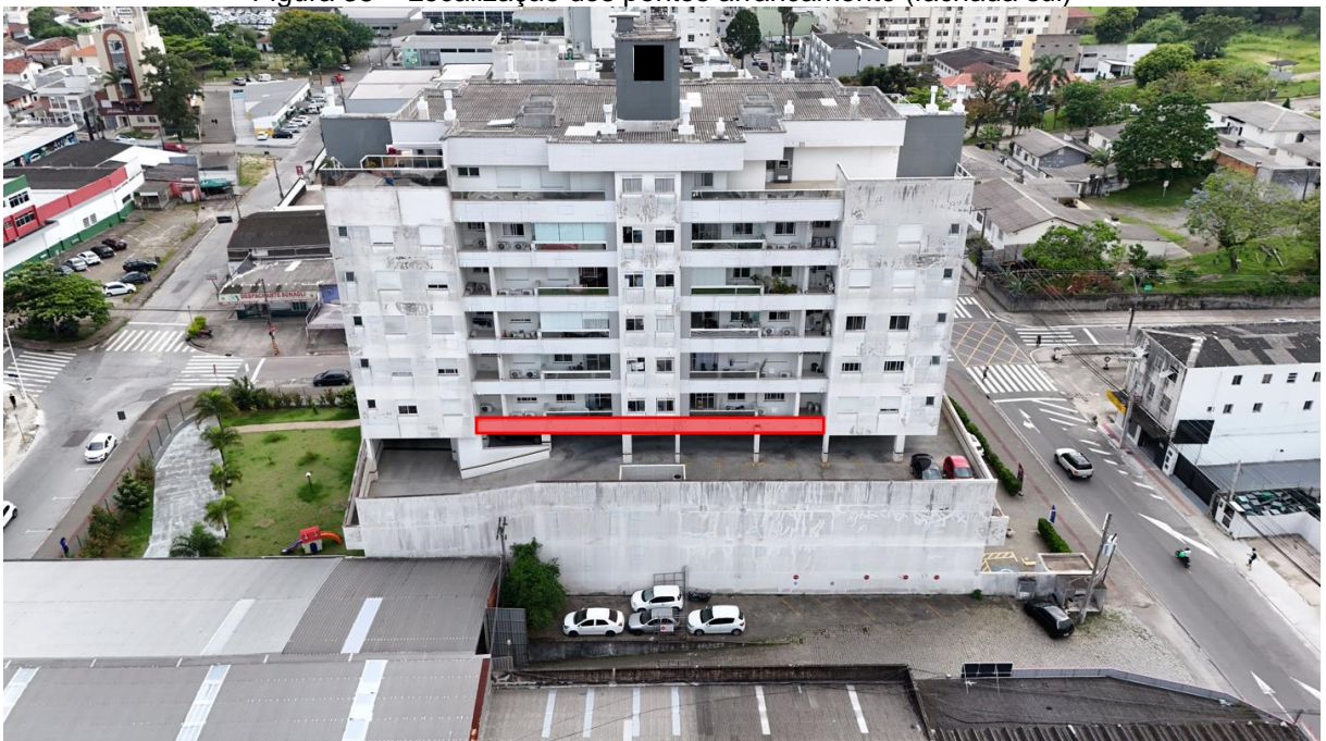
Figura 35 – Localização dos pontos arrancamento (fachada sul)
