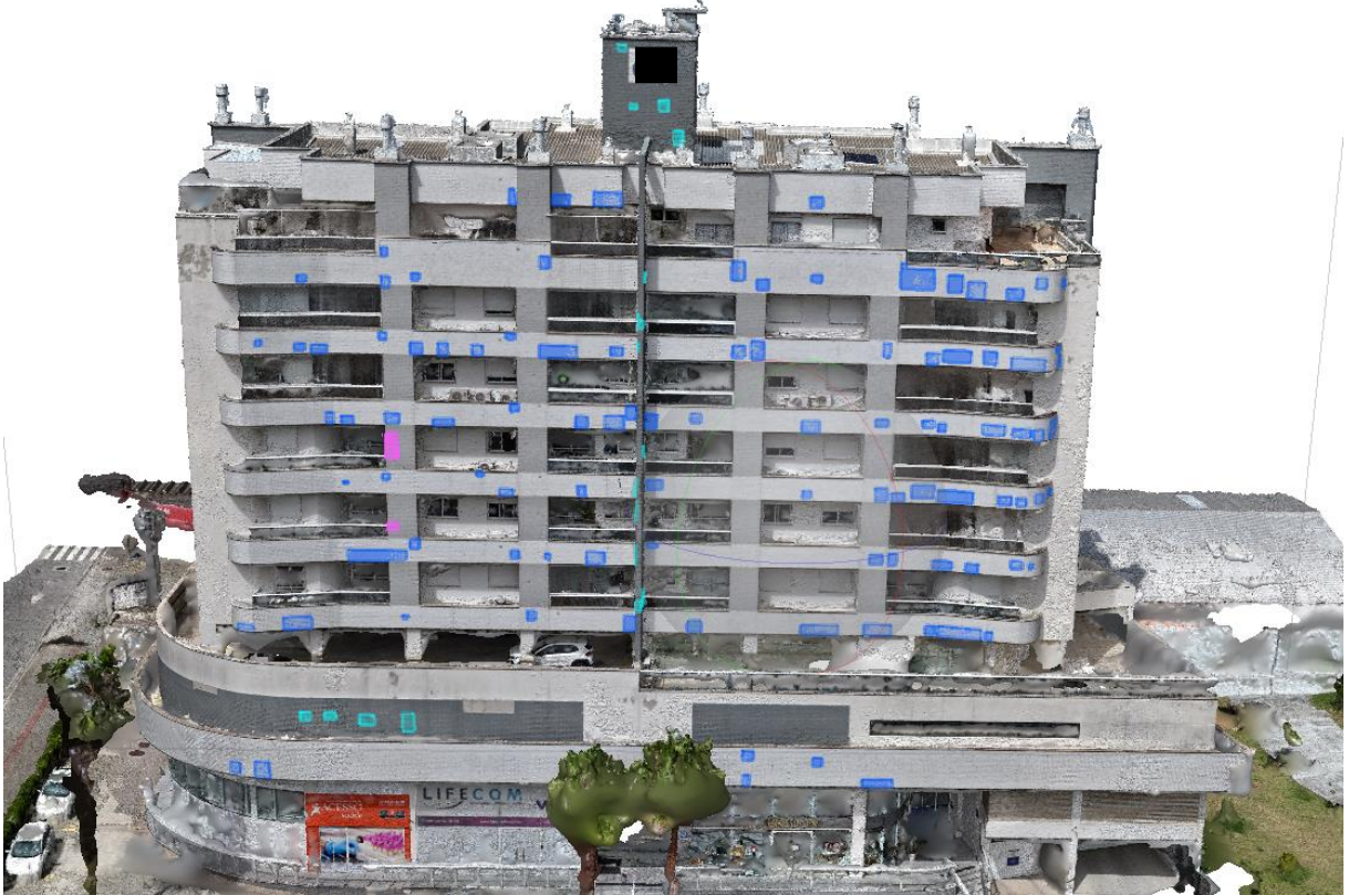
Figura 44 – Modelo 3D da edificação com as marcações com presença de som cavo (fachada norte)
