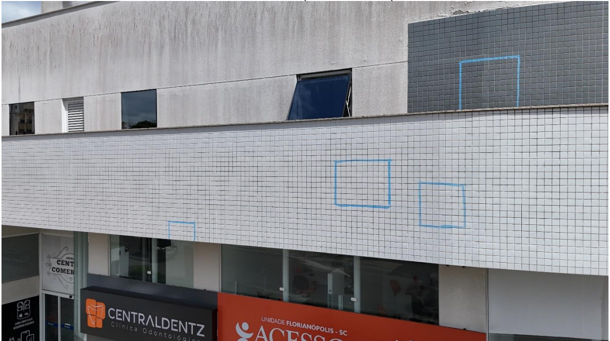
Figura 32 – Deterioração dos rejuntas, manchamentos, excesso de sujidades, bem como marcações de som cavo (fachada Leste)
