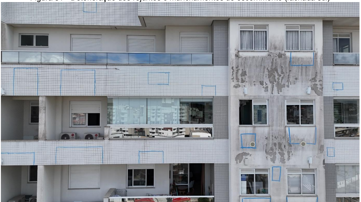
Figura 31 - Deterioração dos rejantes e manchamentos de escorrimento (fachada sul)
