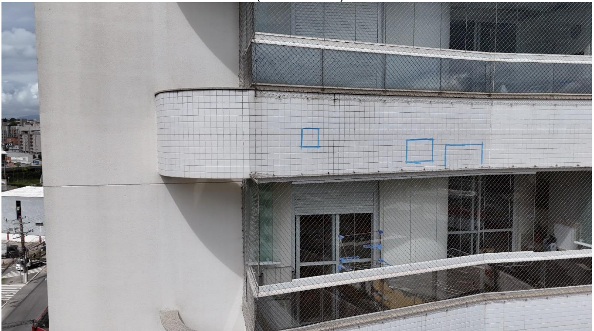
Figura 25 – Manchamentos elevados nas pastilhas, bem como sinais de deterioração do rejunte (fachada norte)
