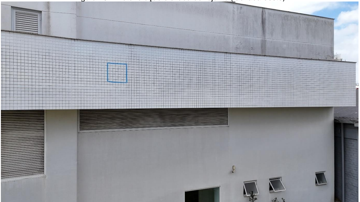
Figura 29 – Deterioração elevada do rejunte (fachada oeste)
