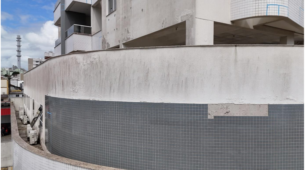
Figura 24 – Sinais de deterioração do rejunte, bem como deslocamento de revestimento cerâmico (fachada norte/leste)
