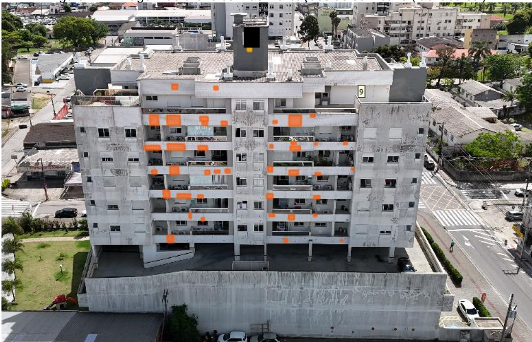
Figura 47 - Imagem de drone com as marcações de som cavo (fachada sul)
