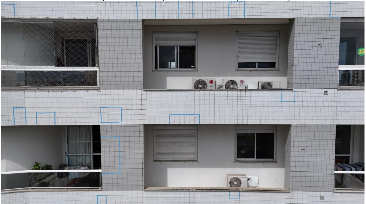
Figura 27 – Manchamentos nos revestimentos cerâmicos, deterioração dos rejuntos, bem como marcações do teste de percussão realizado (fachada norte)
