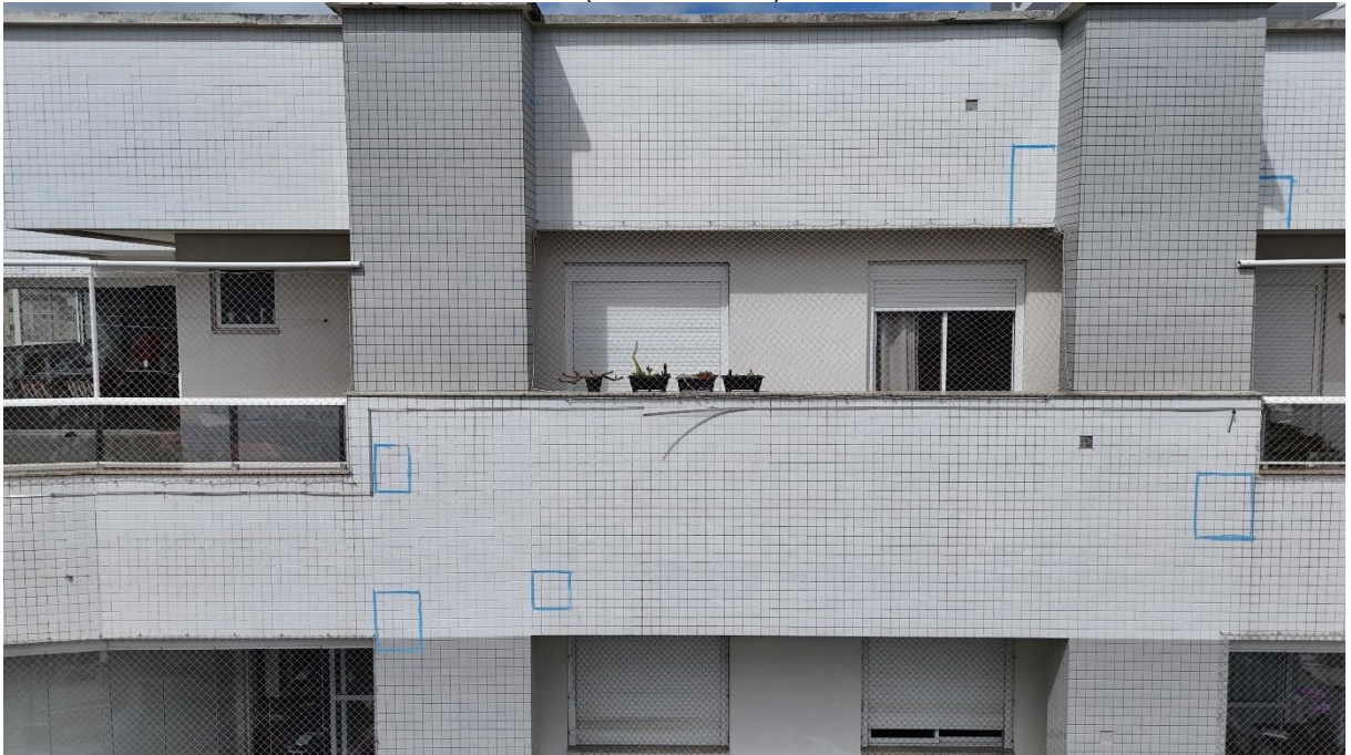
Figura 26 – Sinais de deterioração no rejunte, manchamentos e descolamento de haste do SPDA (fachada norte)
