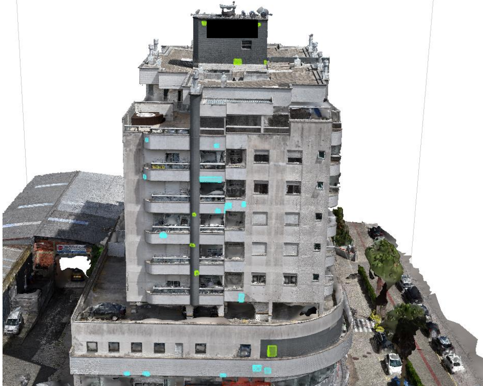
Figura 50 - Modelo 3D da edificação com as marcações com presença de som cavo (fachada leste)
