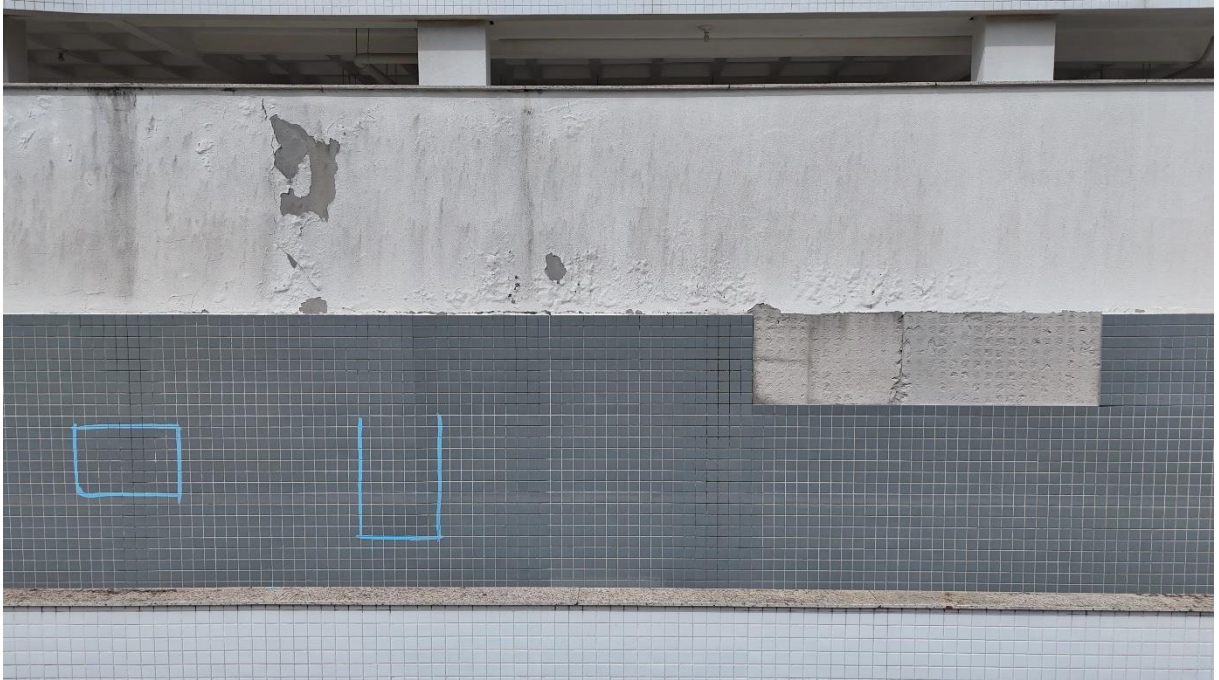
Figura 28 – Deterioração do rejunte, manchamentos e deslocamento do revestimento cerâmico (fachada norte).
