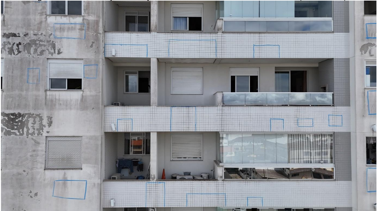
Figura 30 – Deterioração dos rejantes e manchamentos de escorrimento (fachada sul)
