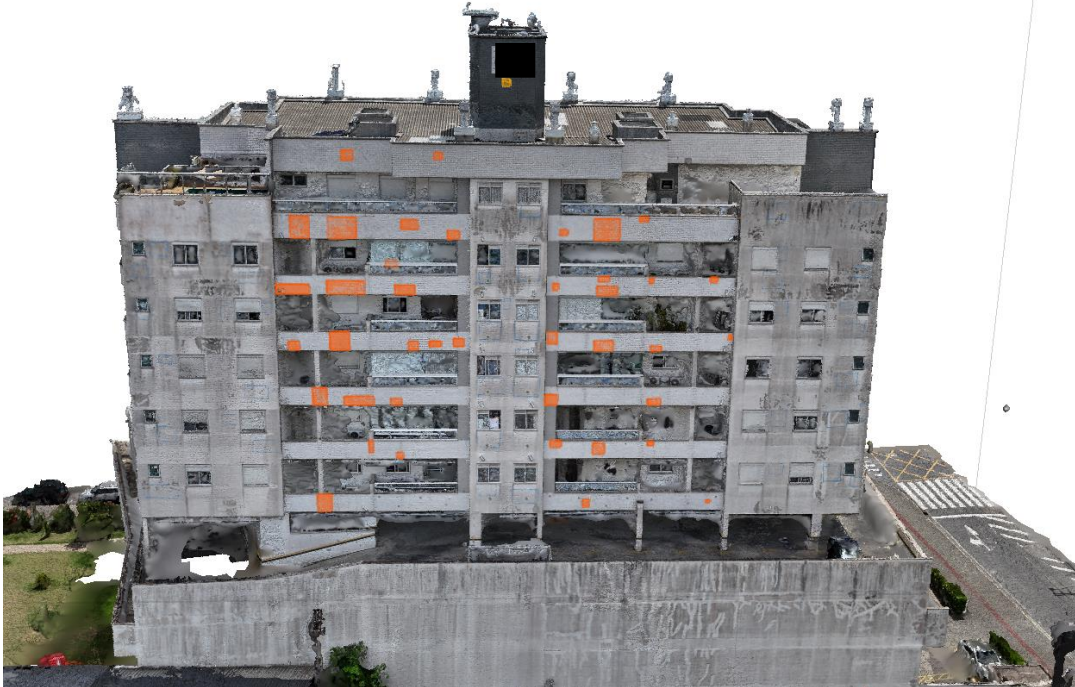
Figura 46 - Modelo 3D da edificação com as marcações com presença de som cavo (fachada sul)
