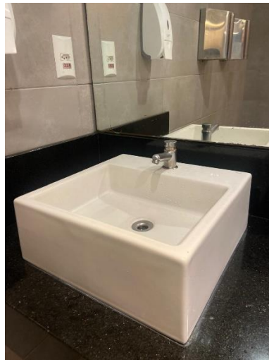
Figura 10 - Torneira de lavatório instalada na academia do bairro Coqueiros.
