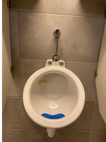
Figura 9 - Mictório instalado na academia do bairro Coqueiros.
