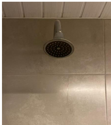
Figura 11 - Ducha instalada na academia do bairro Coqueiros.
