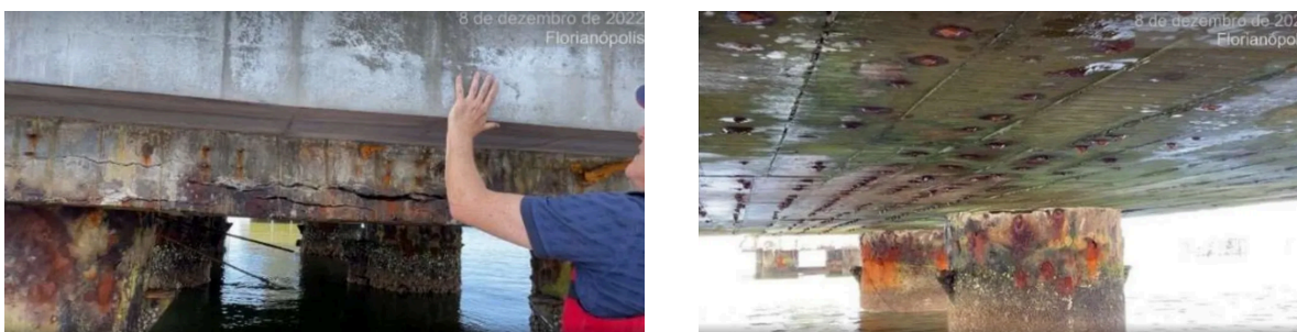
Figura 1 - Corrosão na ponte Colombo Salles
