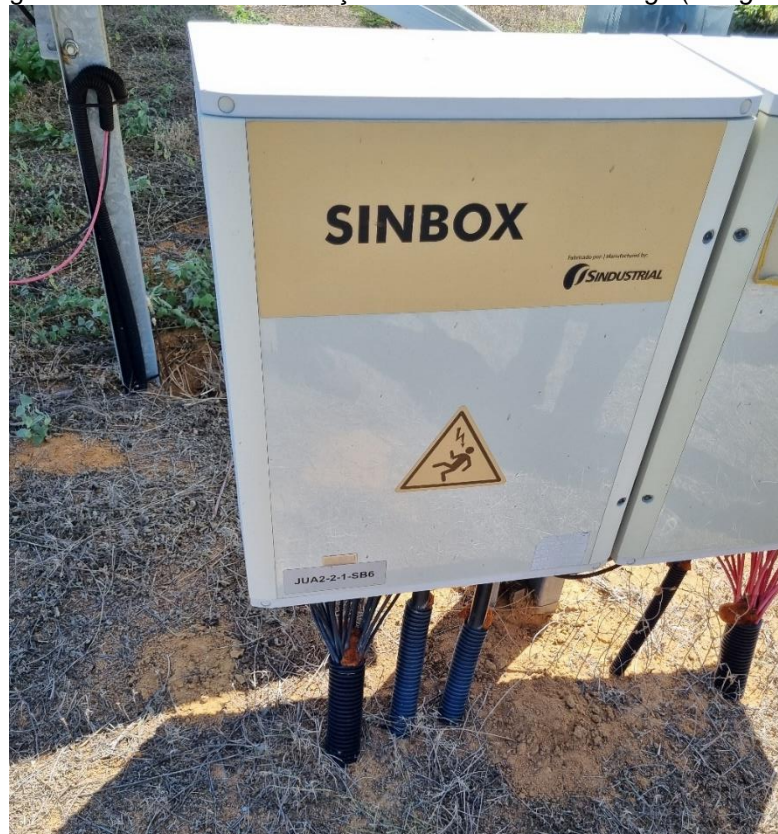
Figura 15 - Caixa de combinação das correntes de strings ( stringbox )
