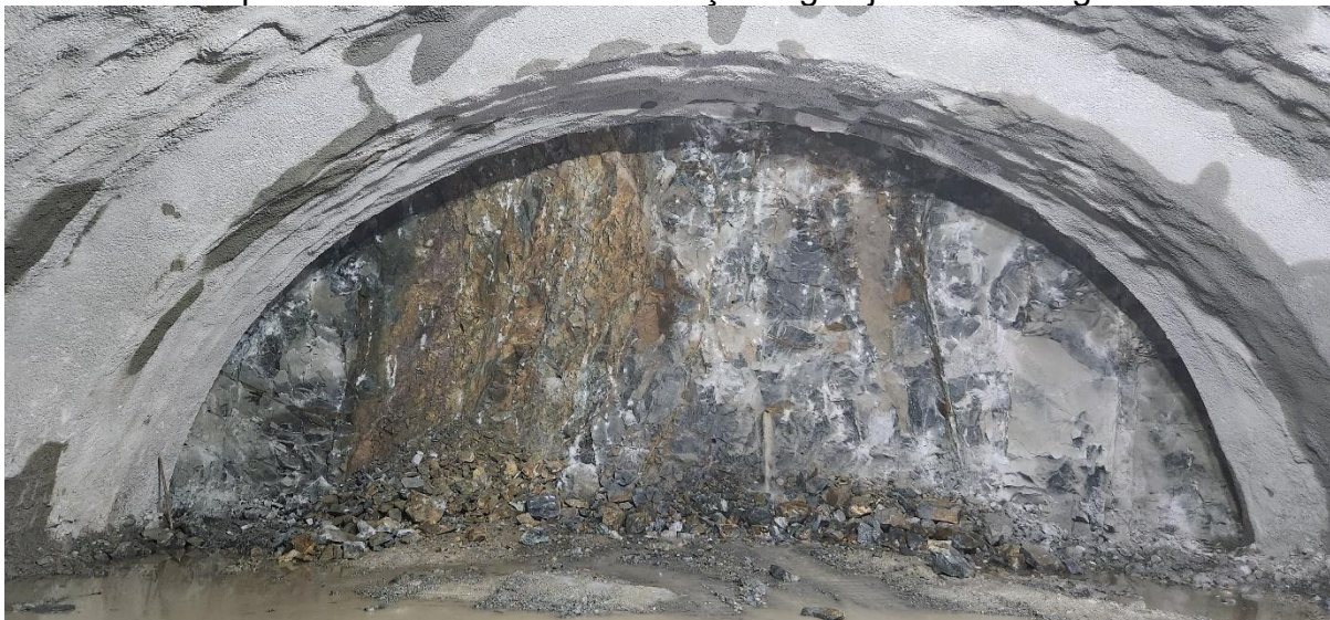
Figura 57 – Frente de escavação estaca aproximada 225+689, pista norte, com presença de zona de cisalhamento com intercalação de rocha alterada mole e rocha alterada dura fragmentada, oxidada e com preenchimento argiloso avermelhado nas superfícies das fraturas. Presença de gotejamento de água.
