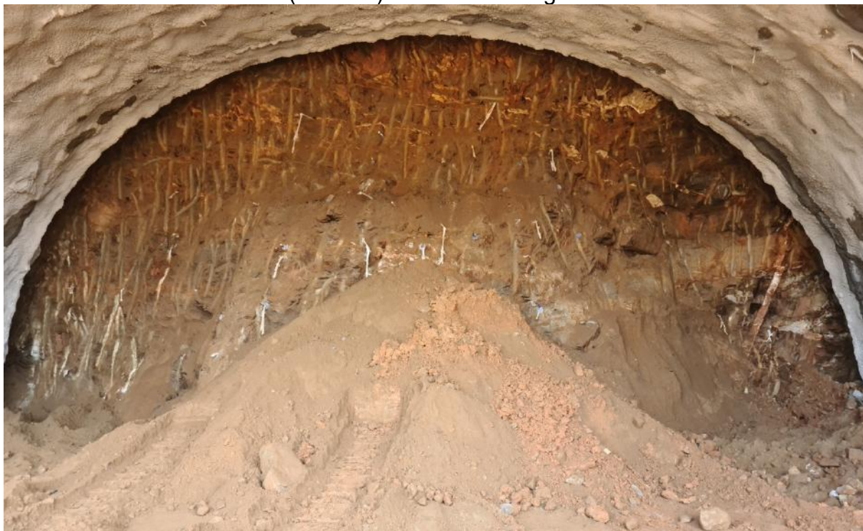
Figura 48 – Seção de escavação da pista sul, emboque sul. Presença de solo residual no teto da escavação, contendo lentes quartzo-feldspáticas (félsicas), lentes micáceas (escuras) e lentes silte argilo-arenosas.
