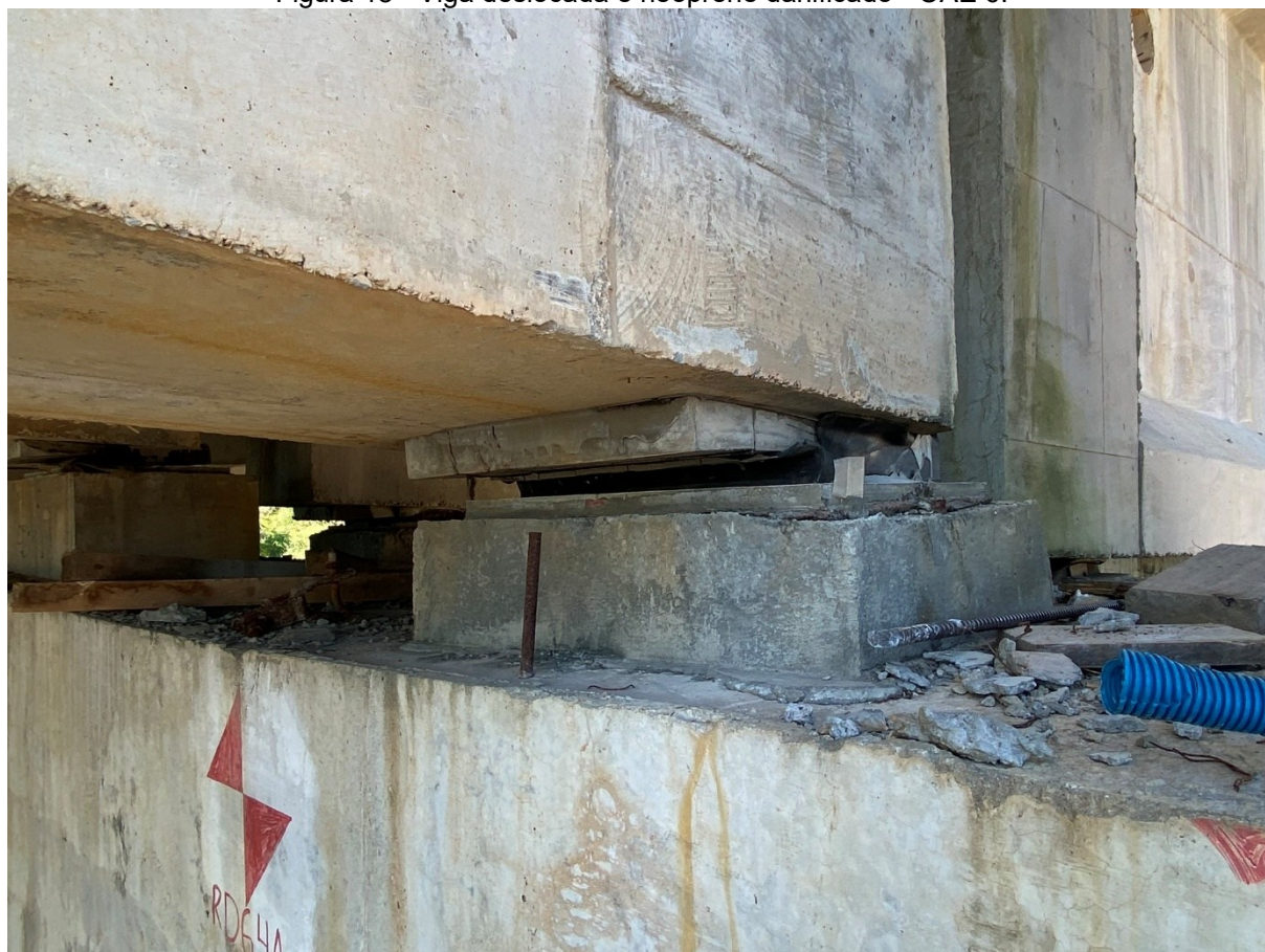
Figura 18 - Viga deslocada e neoprene danificado - OAE 6.
