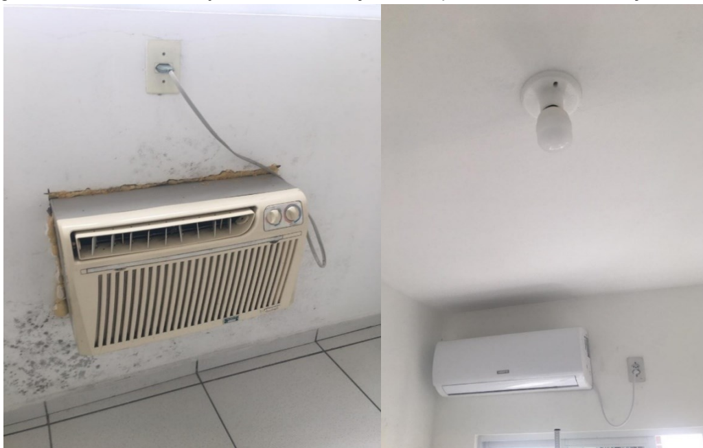
Figura 19: Ar-condicionado janela com instalação inadequada e sinais de infiltração e mofo.
