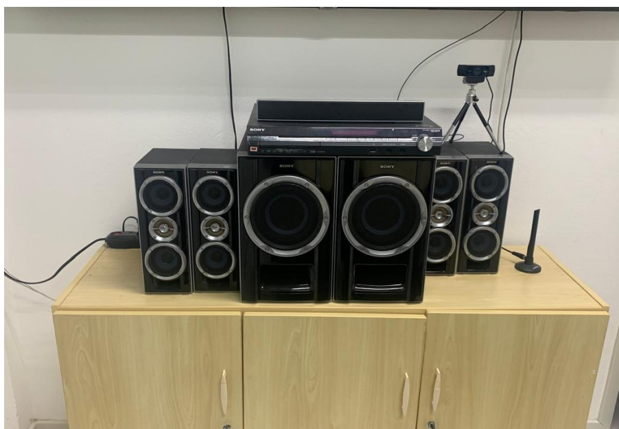
Figura 58 – Sistema de áudio instalado na sala.
