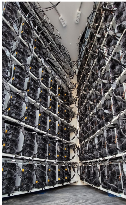
Figura 3 – ASICs de um container de Data Center de mineração de Bitcoin
