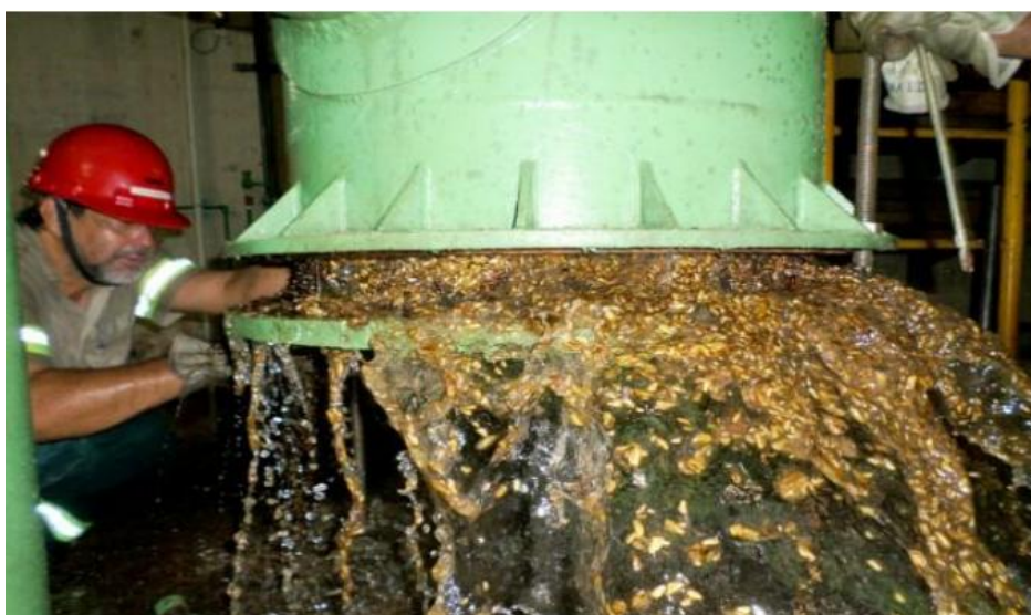
Figura 3-Tubulação com Mexilhões Dourados
