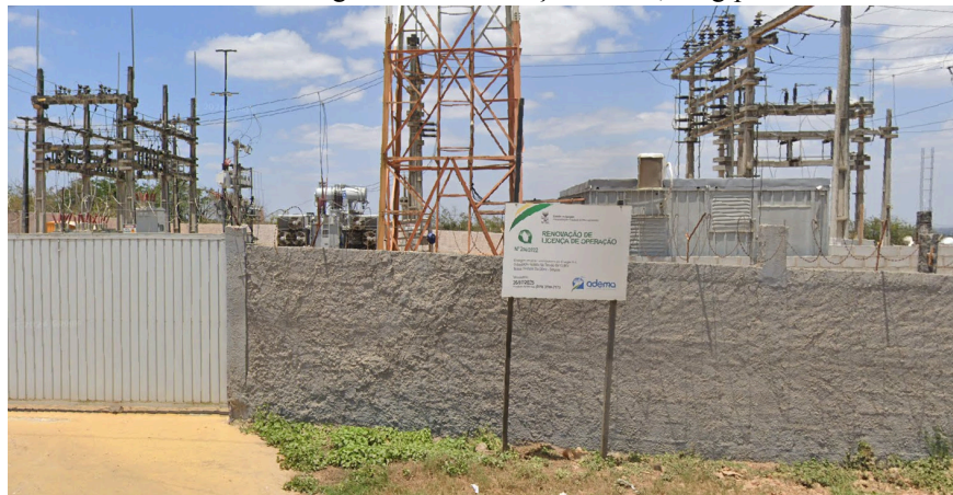
Figura 09 - Subestação Glória, Sergipe.
