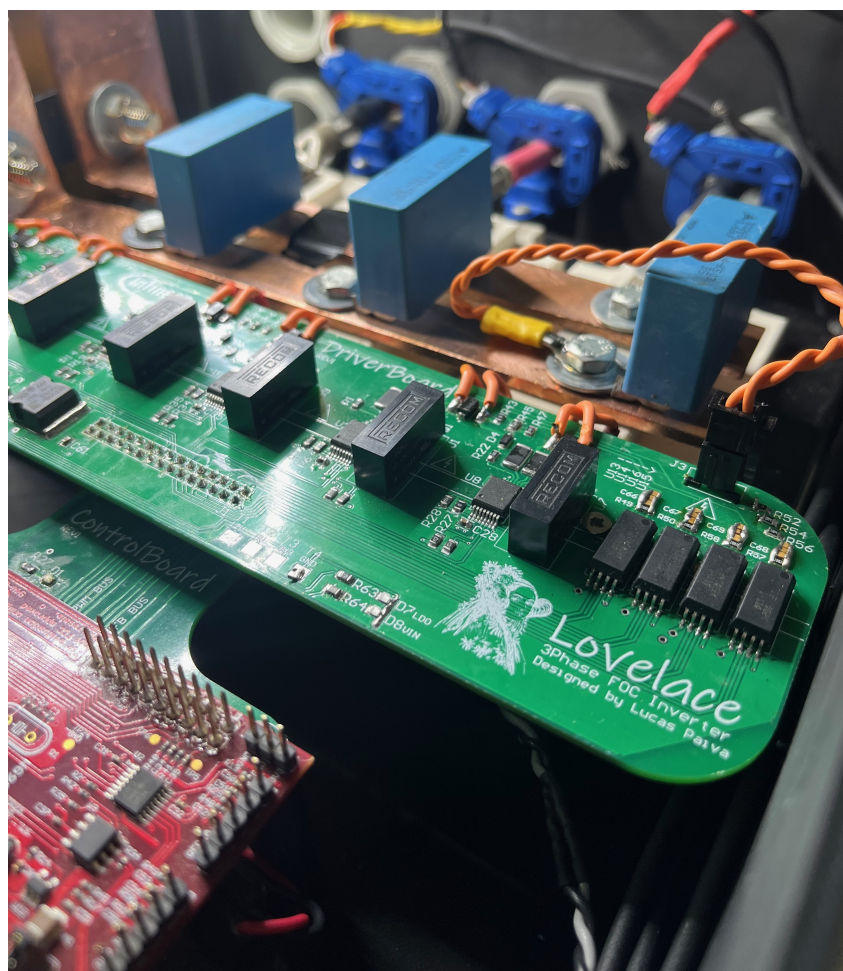
Figura 26 – Placas montadas no interior do inversor.
