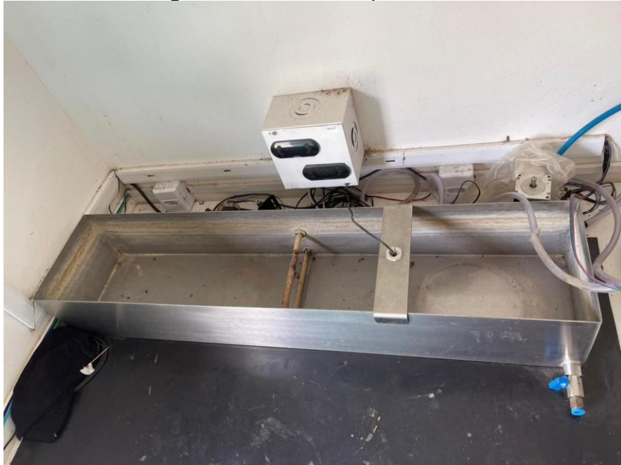
Figura 7 – Bacia de aquecimento
