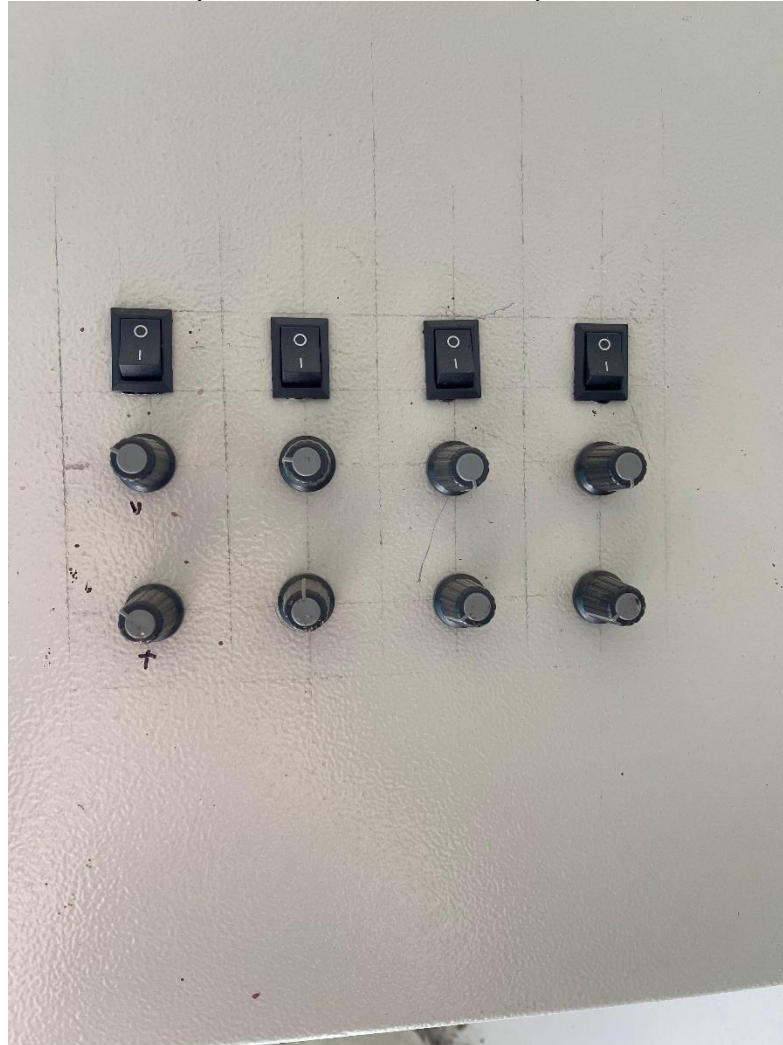
Figura 13 – Porta do painel com os botões e potenciômetros instalados
