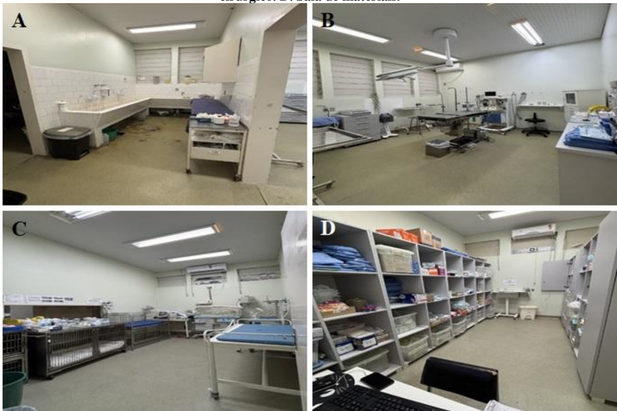
Figura 7. Centro cirúrgico. A. Lavatório. B. Segunda sala cirúrgica. C. Sala de recuperação no pós-cirúrgico. D. Sala de materiais.
