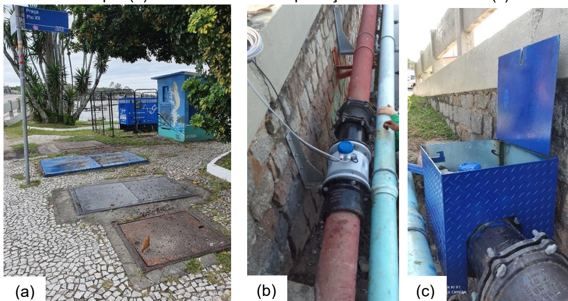
Figura 19- Estação Elevatória da Ponte (a), instalação do medidor na linha de recalque (b) e caixa metálica de proteção do macromedidor (c).
