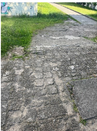
Figura 82 Pavimentação inadequada no passeio com participante P6M2540
