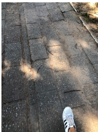
Figura 83 Pavimentação inadequada no passeio com participante P7M2540
