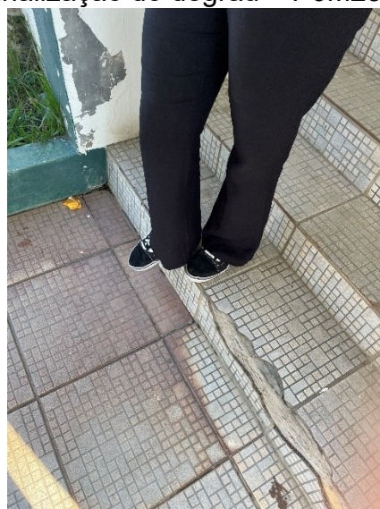
Figura 89 Relato sobre a falta de sinalização do degrau – P6M2540
