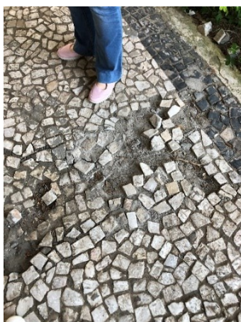
Figura 81 Pavimentação inadequada no passeio com participante P3M4055
