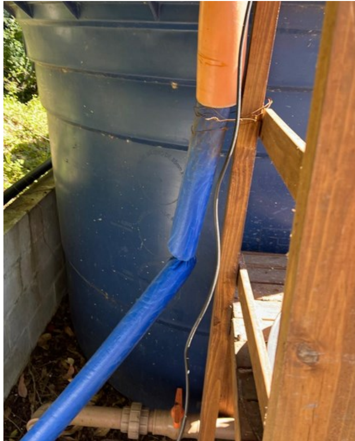
Figura 33: Imagem fotográfica capturada evidenciando o estrangulamento observado na adaptação provisória no sistema de bombeamento/alimentação de lodo nos módulos WCL TS .
