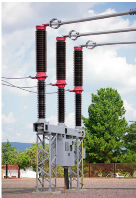
Figura 10 – Disjuntor Siemens modelo 3AP1 FG 145 kV. Fonte: Frontin (2013).
