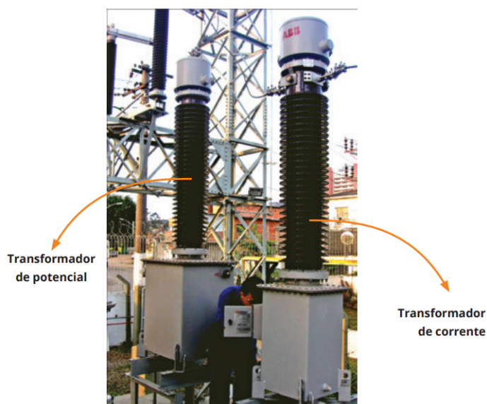
Figura 13 – Transformador de Potencial e Transformador de Corrente. Fonte: Frontin (2013).
