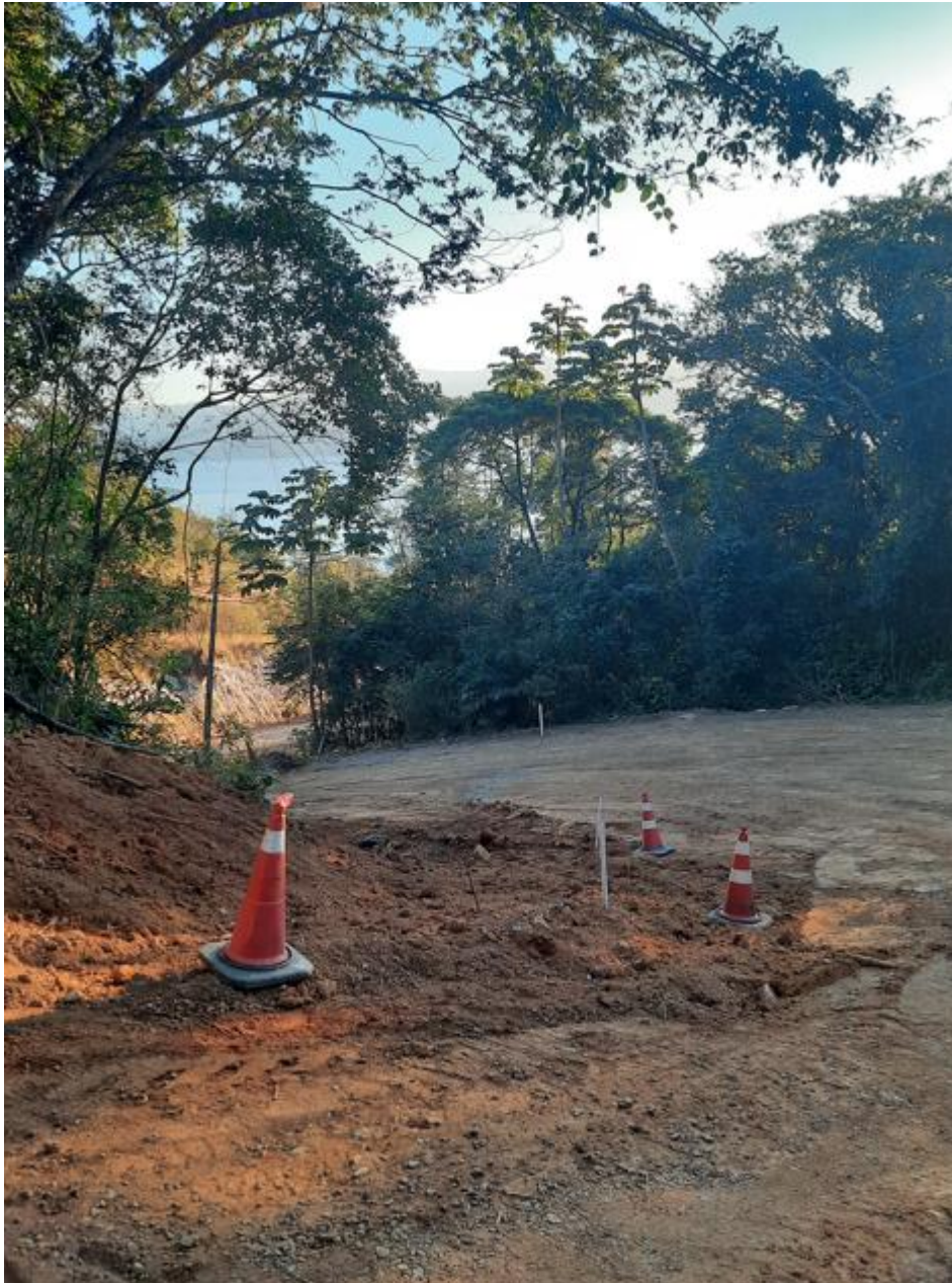
Curva antes do mirante, com cones de sinalização marcando área remexida pela chuva nos dias anteriores. Fonte: Autor (novembro de 2020).
