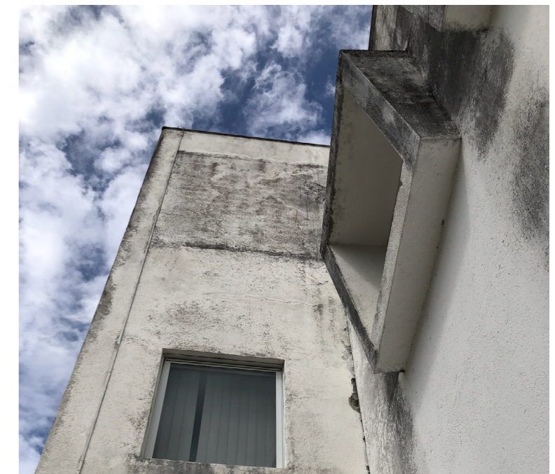
detalhe do reboco caindo do prédio branco, arq.&urb UFSC, 2025. Fonte: autor
