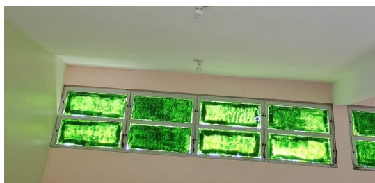
Figura 80 - Janela com pintura escura (Bloco A)
