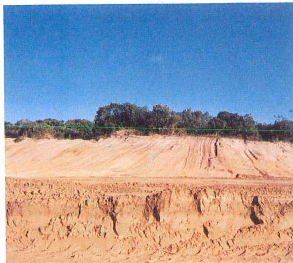
FIGURA 33 – Terraplanagem realizada sobre as dunas para duplicação da estrada liga o Pântano do Sul ao Balneário dos Açores e à localidade da Costa de Dentro. (ago. / 98)
