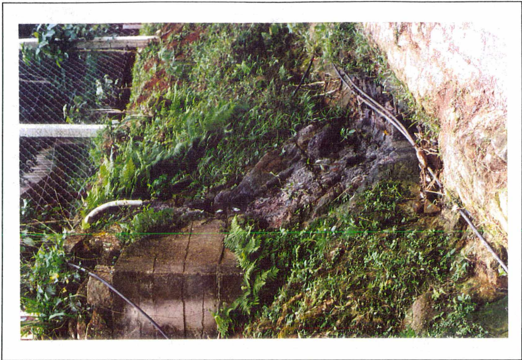
FIGURA 42 – Mangueiras de abastecimento de água localizadas dentro de valas por onde escoa o esgoto das residências no morro do Teófilo.
