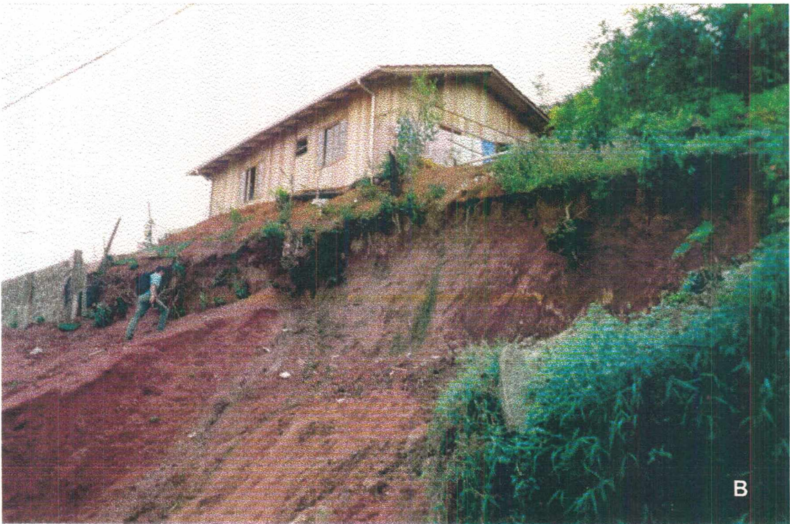
Figura 6.3: Ponto sob perigo iminente de deslizamento, localizado na servidão Betânia (A - Vista panorâmica. B – detalhe do corte)
