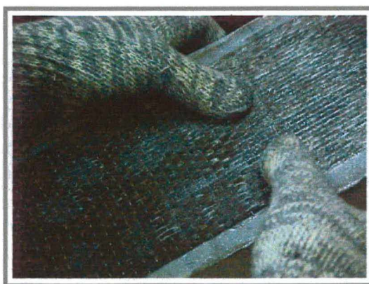
Figura 5.20 – Pressionamento da manta de fibra de carbono e retirada do excesso de resina
